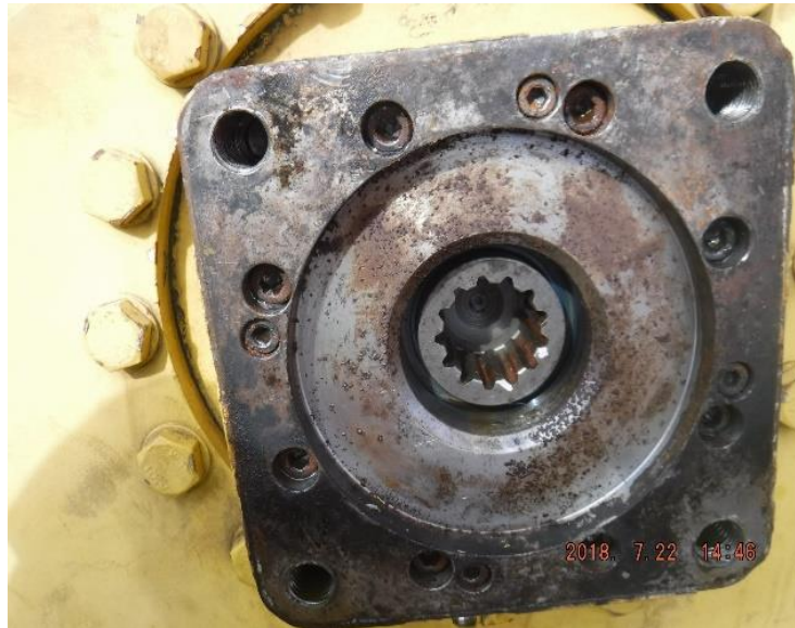
Figura 37. Flange do motor com corrosão.
