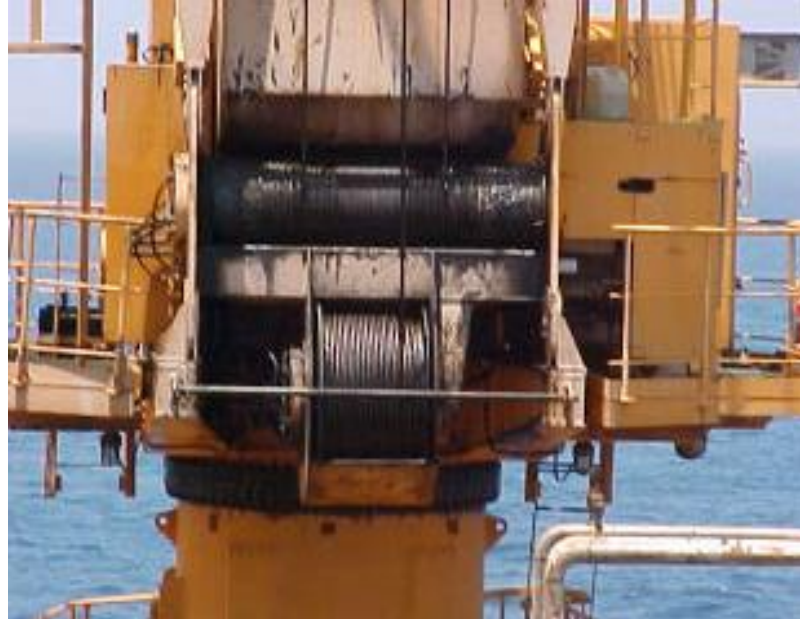
Figura 6. Guincho de um guindaste offshore.
