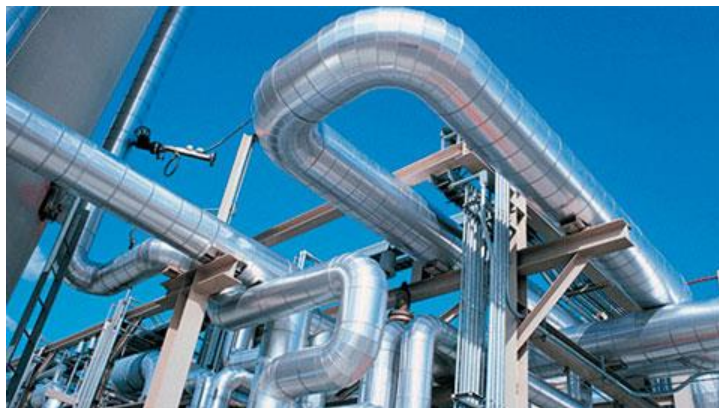
Figura 47 - Tubulação de alta pressão. Fonte: Monteiro tubulações e caldeiraria.
