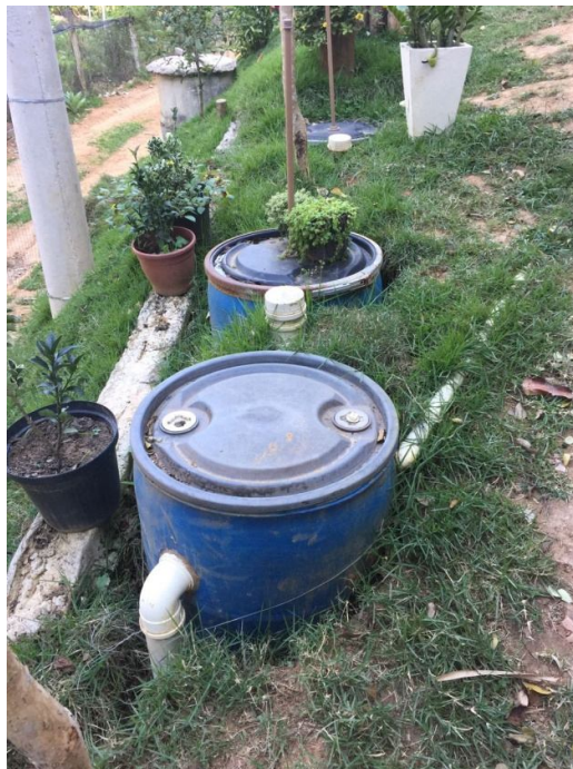
Figura 29: Sistema de tratamento de esgotos adaptado no município de Pinheiral, para uma propriedade rural que contém três moradores.
