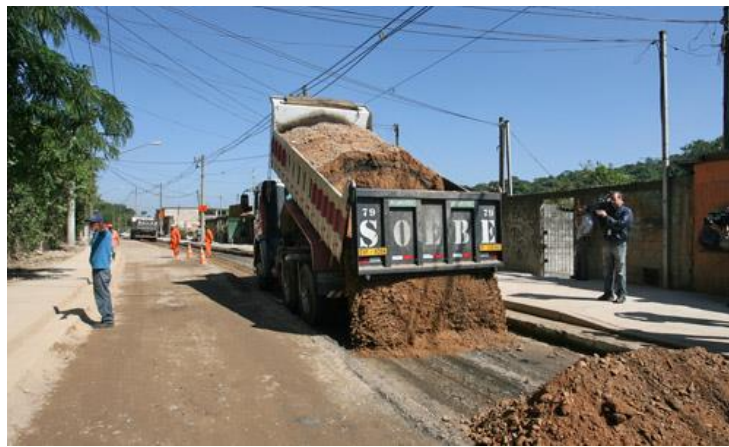
Figura 10: Preparação de base e sub-base com material de entulho (pavimentação) Fonte: Secretaria Especial de Comunicação (prefeitura.sp.gov.br)
