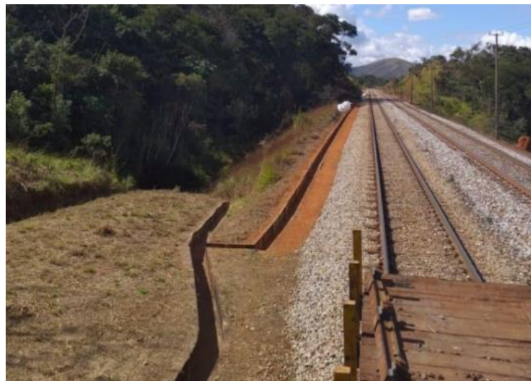
Figura 4: Sistema de drenagem na MRS Logística S.A - Ferrovia do Aço.
