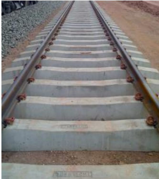
Figura 11: Dormente de concreto na via.
