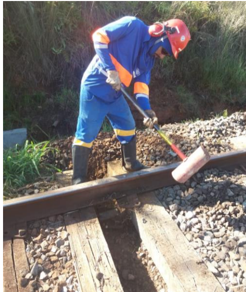
Figura 43: Deslizamento da placa de apoio.
