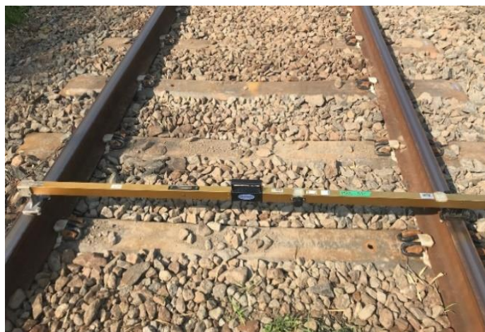
Figura 30: Régua de bitola e superelevação.
