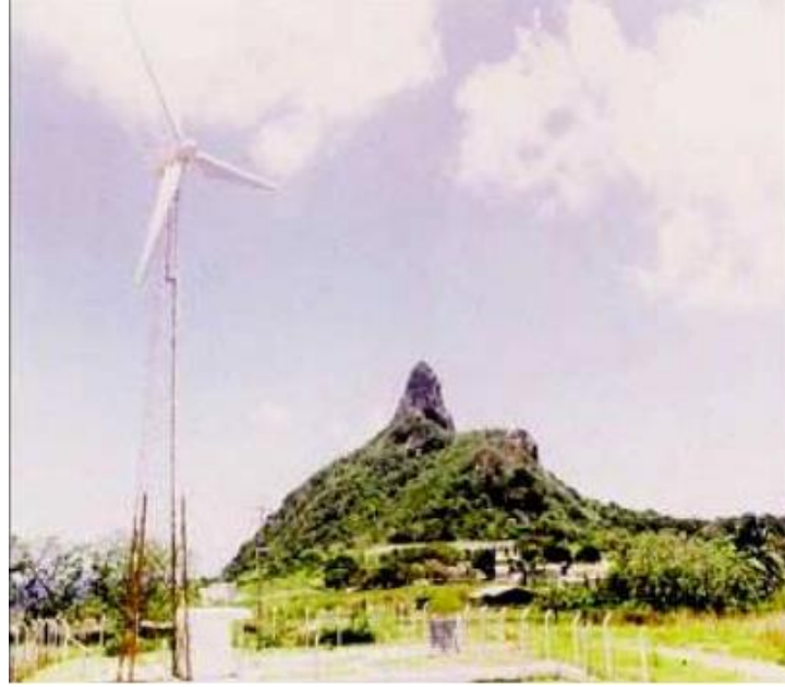
Figura 9 - Primeira turbina instalada no Brasil, Fernando de Noronha – Pesquisado em: < http://www.memoriadaeletricidade.com.br >
