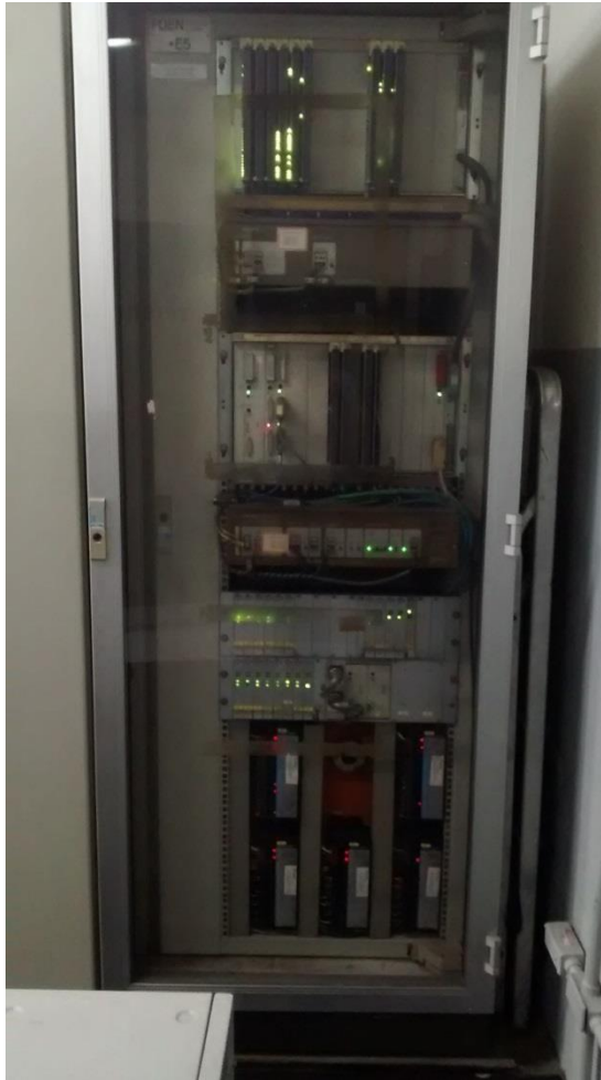
Figura 28 - PLC Simatic Step 5 usado atualmente.
