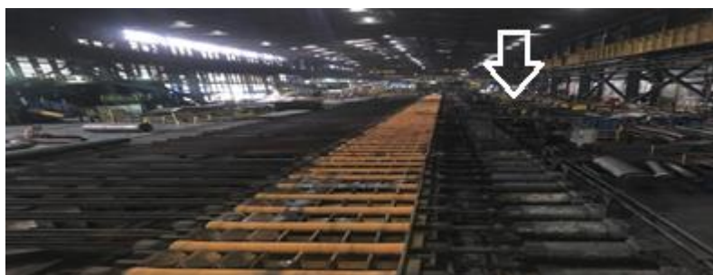
Figura 10 – Aplicação dos motores na Mesa de Rolos H1
