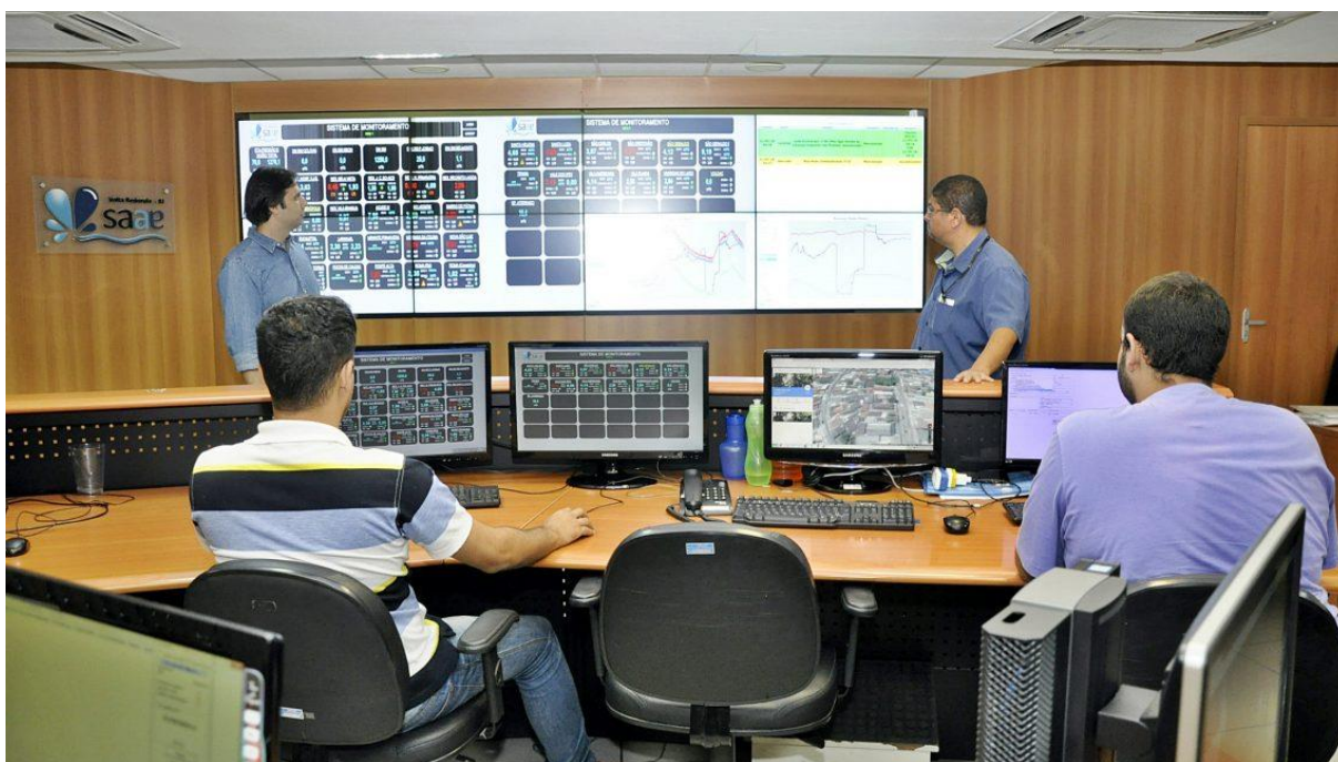
Fotografia 2 – Centro de Controle Operacional
