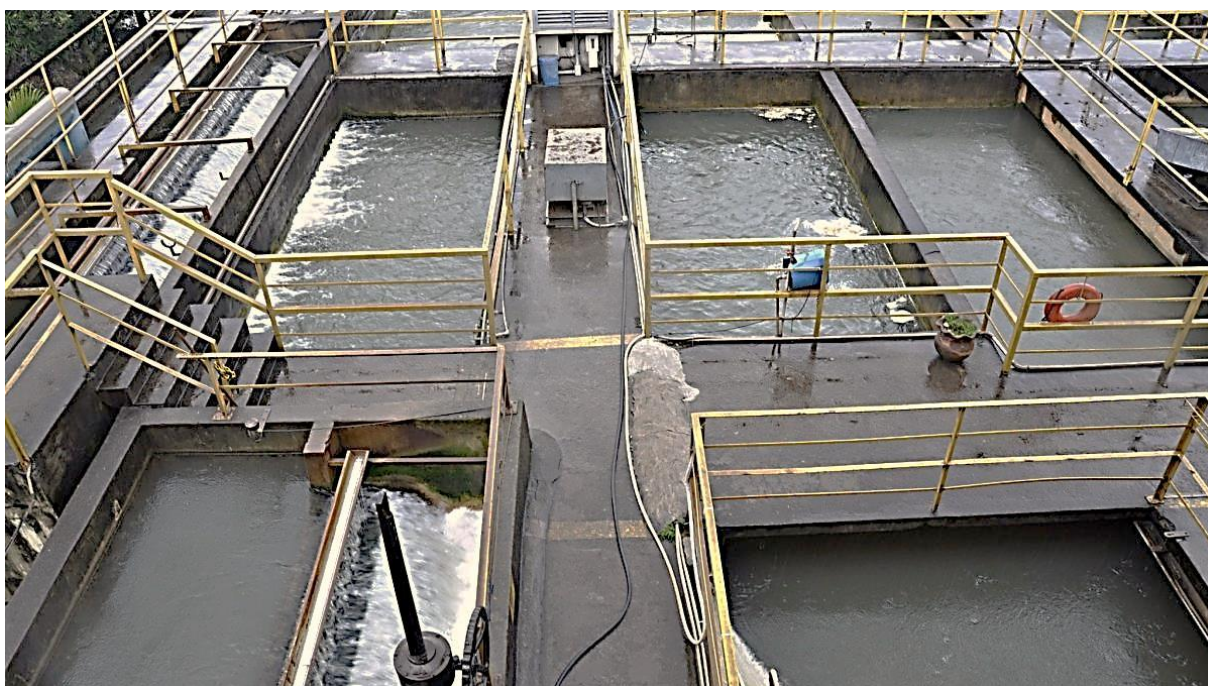
Fotografia 1 - Estação de Tratamento
