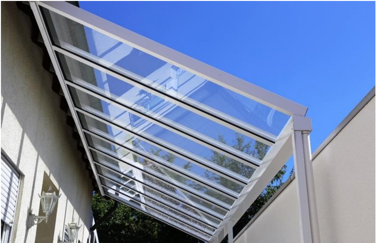
Figura 16: policarbonato em estrutura de alumínio.
