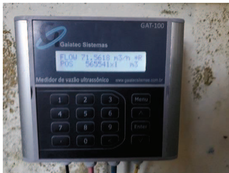
Figura 19 - Display do Medidor de Fluxo Ultrassônico de entrada [11]
