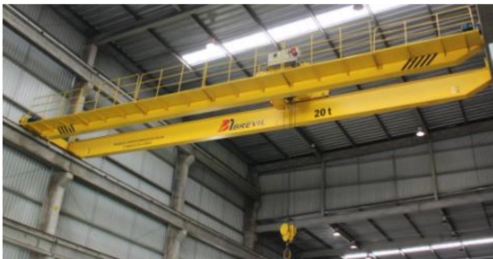
Figura 5. Ponte Rolante Biviga
