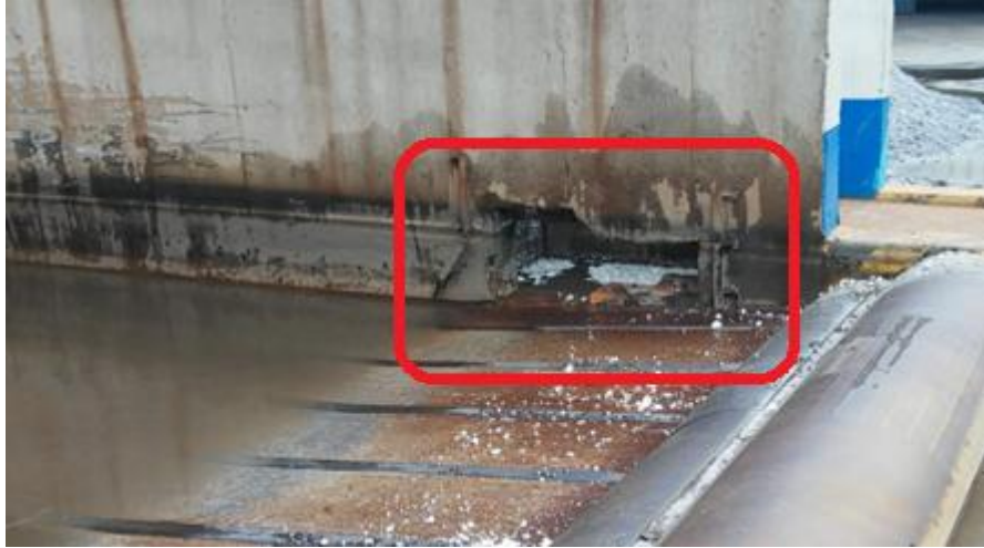
Figura 36: Falta de tela de filtragem saída tanque de resfriamento
