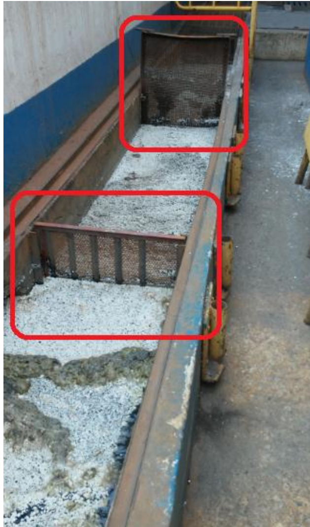
Figura 37: Telas de filtragem existentes montada na canaleta
