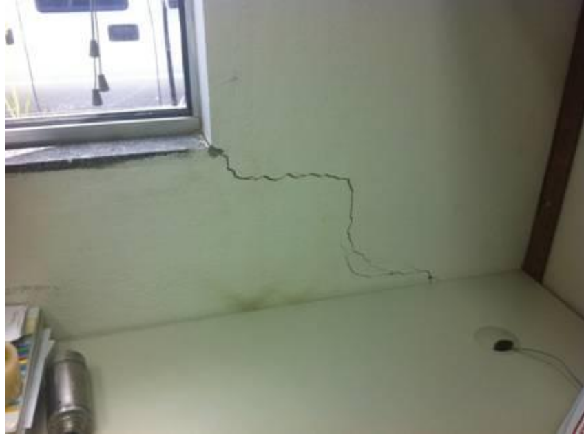
Figura 7: Trinca em Alvenaria estrutural. Fonte: A5 ENGENHARIA, blogsite 2017
