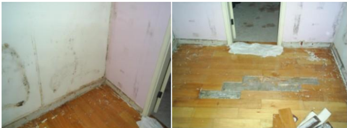
Figura 3 e 4: Falhas no revestimento do piso e nas paredes devido à infiltração de água. Fonte: PEREIRA et al. 2017
