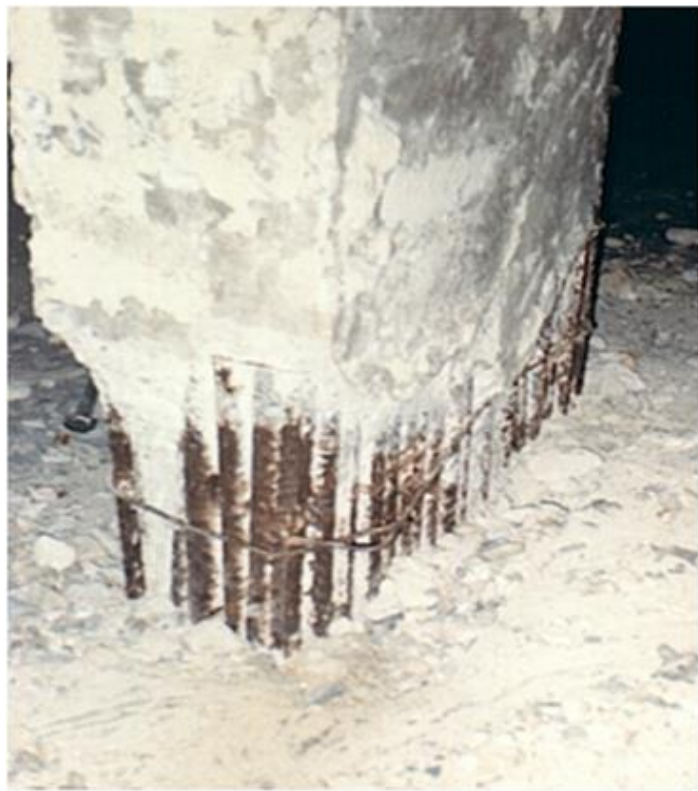
Figura 6: Danos no pilar e corrosão da armadura. Fonte: RODRIGO CARVALHO, ARTIGOS. 2017
