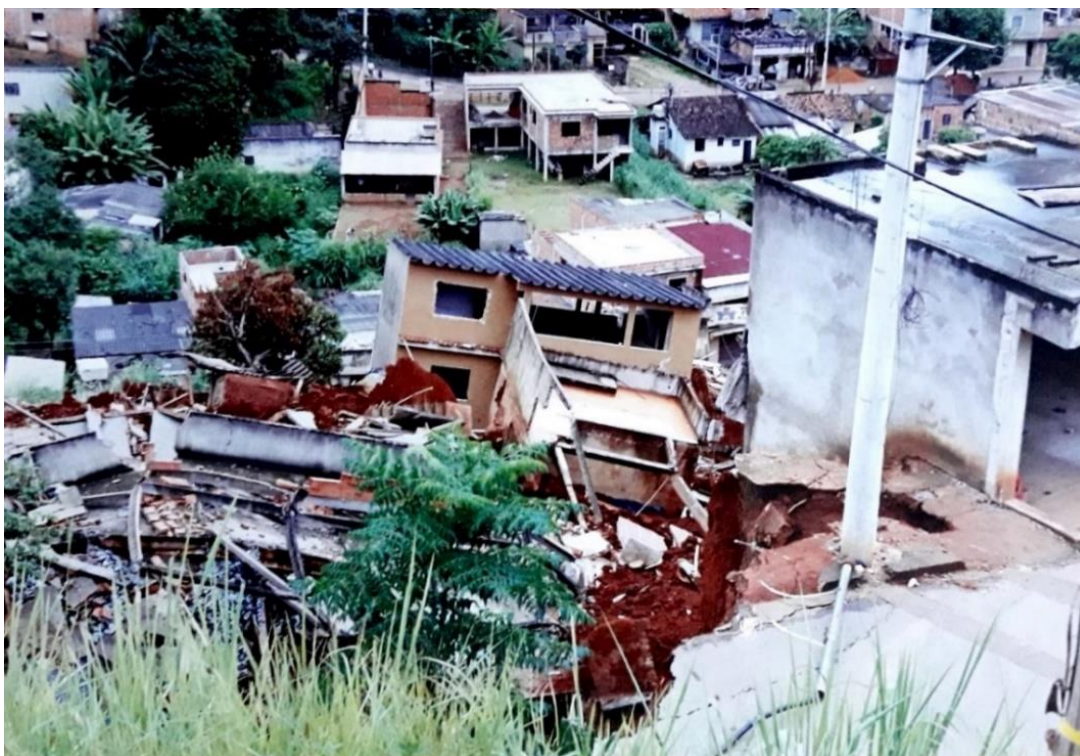
Figura 16 - Casas atingidas pela movimentação de massas de terra. Fonte: Arquivo pessoal do orientador (1999).
