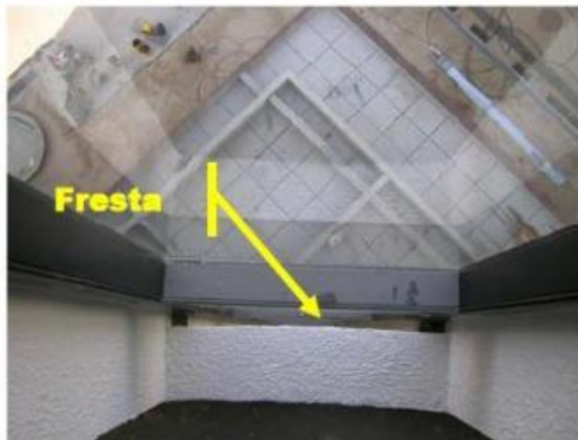
Figura 18 – Fresta entre a estrutura de esquadrias e a supra estrutura do edifício. (Fonte: CAMPOS e CONCEIÇÃO, 2006)
