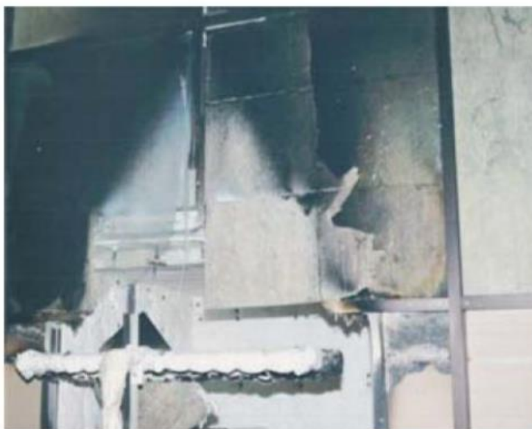
Figura 26 - Colapso do isolamento de lã de rocha adjacente à barreira periférica contra fogo (Fonte: NICHOLAS, 2005)
