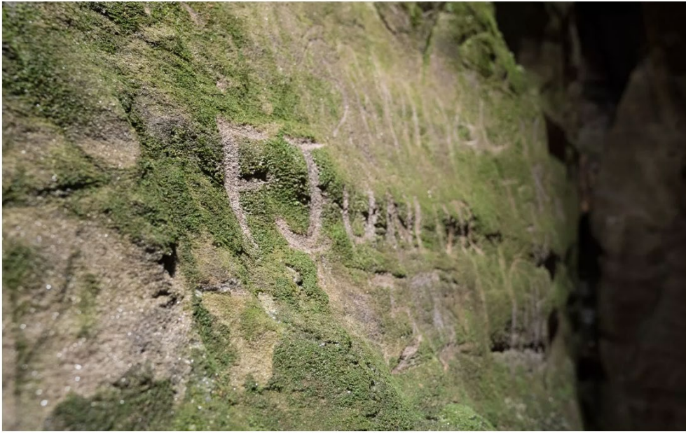
Parque Estadual do Ibitipoca - marcas deixadas por turistas nas paredes de grutas são alvo de inquérito — Foto: Dimas Stephan/G1
