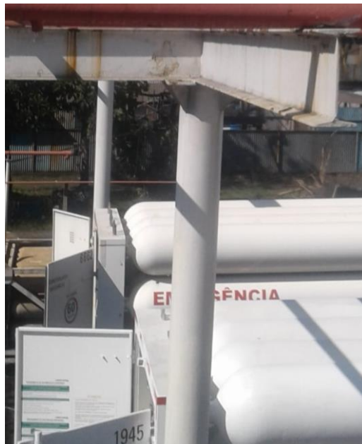
Figura 26 - Posicionamento das carretas frente à estrutura de sustentação dos sprinklers
