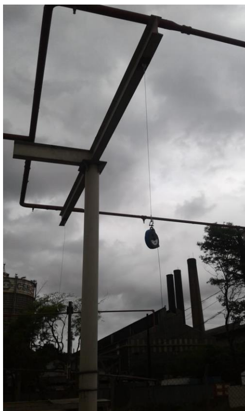
Figura 27 - Balancim fixo com cabo de aço à estrutura de sustentação dos sprinklers
