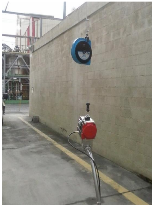
Figura 29 – Balancim junto à mangueira de enchimento das carretas Fonte: Foto do autor
