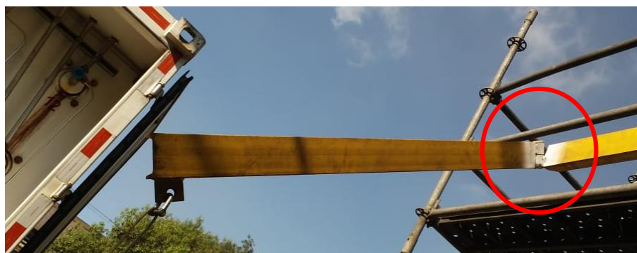
Figura 18 - Pórtico de sustentação do balancim (estrutura danificada)
