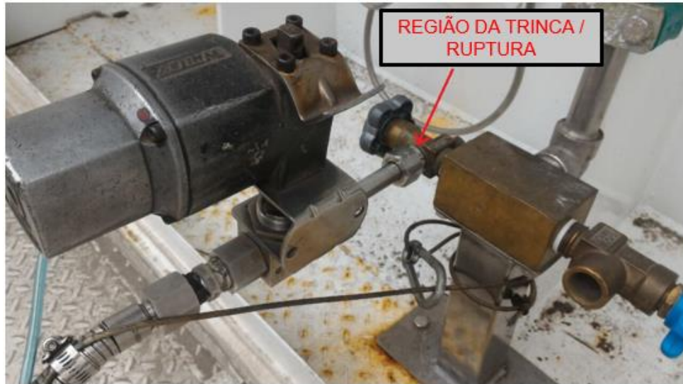
Figura 16 - Conjunto de abastecimento conectado ao bloco manifold da carreta
