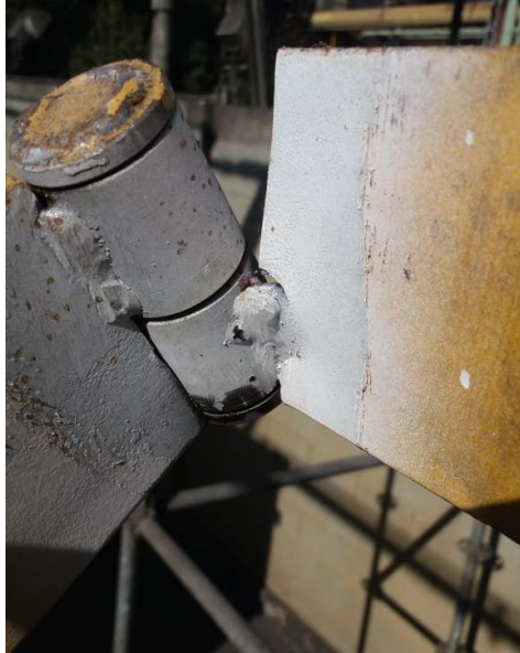
Figura 19 - Região ampliada da junta soldada após acidente
