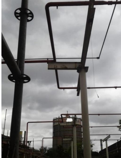
Figura 25 - Estrutura de sustentação do sistema de combate à incêndio
