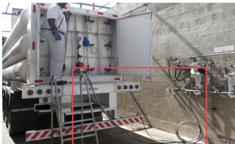
Figura 23 - Compartimento traseiro da carreta, com ênfase para mangueira de enchimento
