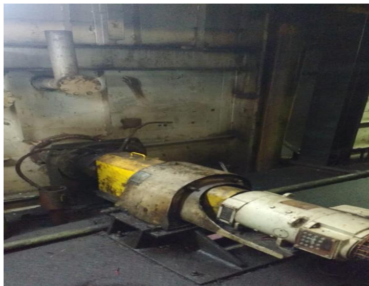
Figura 47: Conjunto de acionamento dos rolos do forno de recozimento da linha de zincagem
