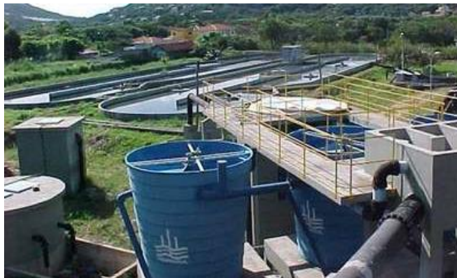
Figura 1 – Ete – Estação de tratamento de efluentes situada em Lagoa da Conceição.
