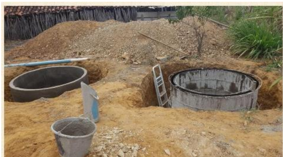
Figura 16. Preparação de cisterna e filtro de alvenaria em sistema de tratamento de águas cinzas.
