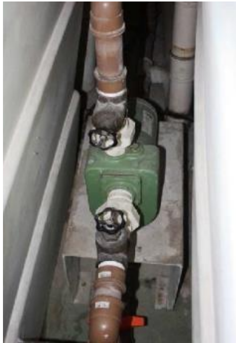
Figura 10. Bomba centrífuga de recirculação de lodo do DEC.
