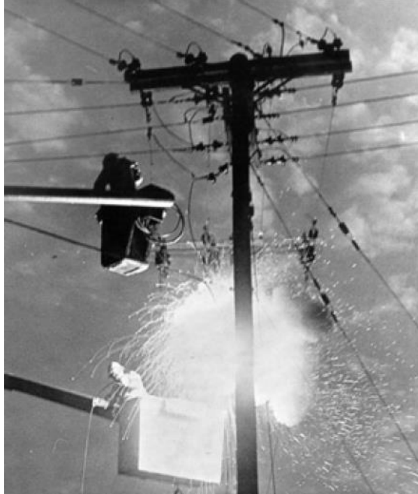
Figura 11 – Ocorrência de arco elétrico não controlado Fonte: SENAI 2011
