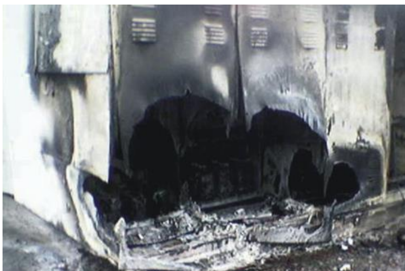
Figura 14 - Danos causados em painéis elétricos pela energia incidente Fonte: SENAI 2011
