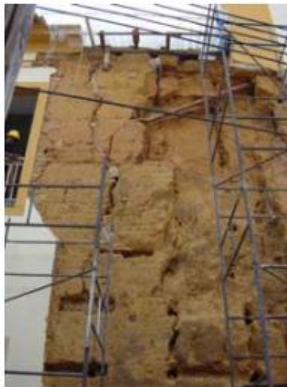
Figura 38 - Estrutura muraria após desprendimento.
