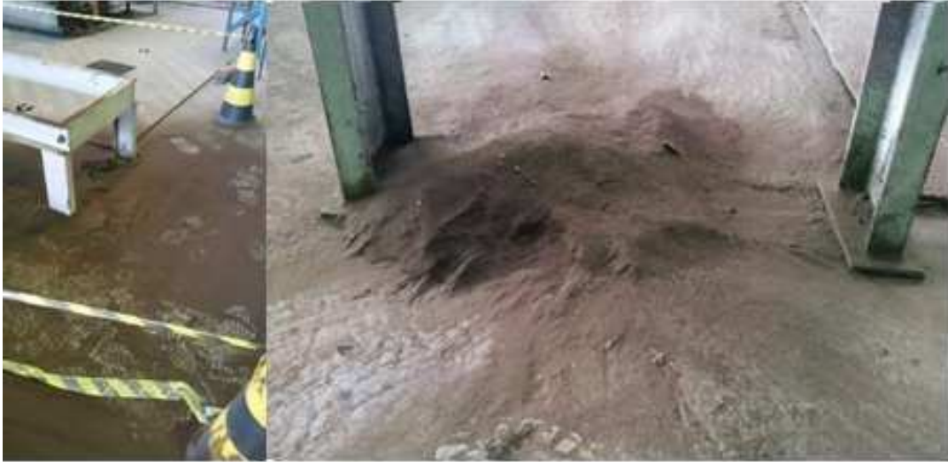
Figura 28: Pó proveniente da limpeza do filtro
