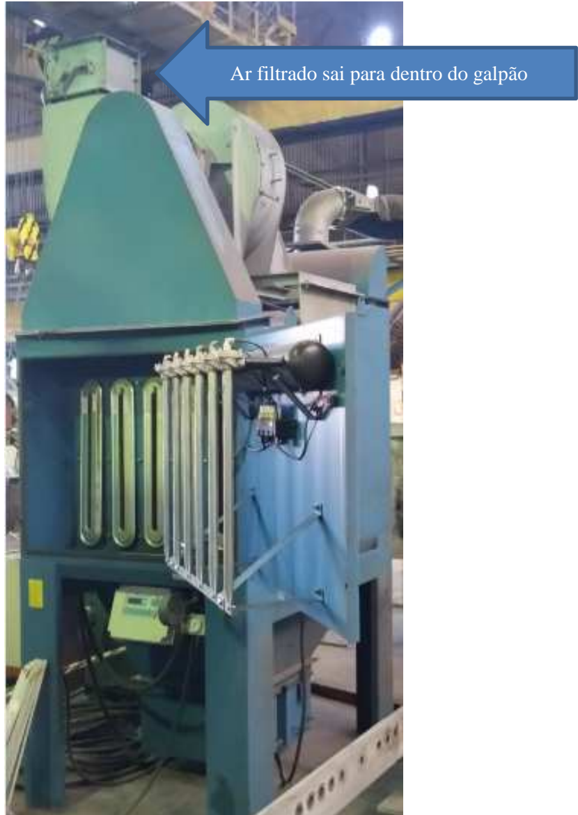
Figura 33: Sistema de exaustão e filtragem de fumos
