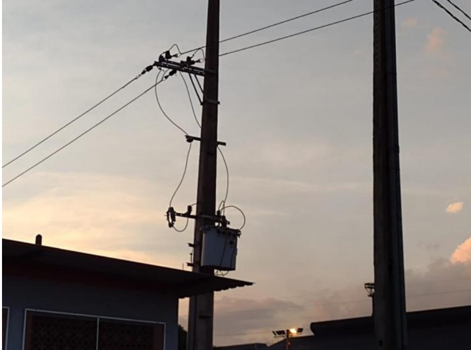
Figura 3 – Transformador na saída da subestação Fonte: (Própria, 2020)
