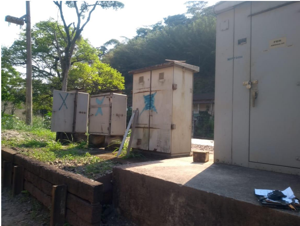
Figura 11 – Abrigos de locação das baterias para as chaves telecomandadas Fonte: (Própria, 2020)
