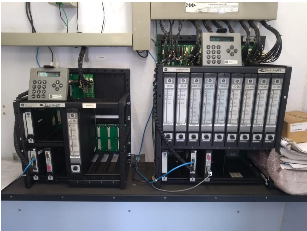
Figura 33 – EletroLogIXS EC5 em um dos abrigos do trecho Fonte: (PRÓPRIA, 2020)
