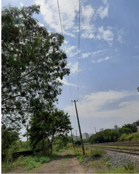
Figura 1 – Linha do sistema elétrico ferroviário paralela aos trilhos Fonte: (Própria, 2020)
