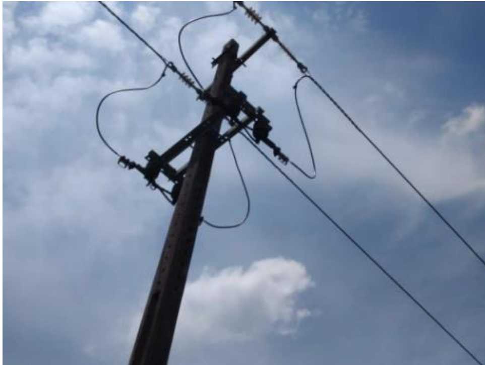
Figura 10 – Chave telecomandada Fonte: (Própria, 2020)
