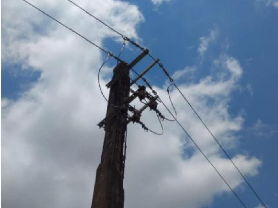
Figura 7 – Alimentador de distribuição ferroviária bifásico Fonte: (Própria, 2020)
