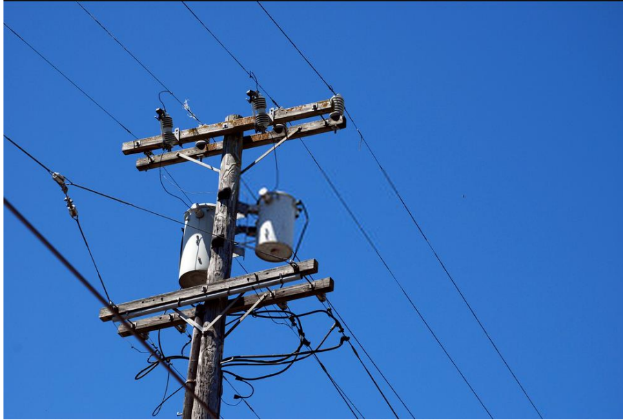
Figura 8 – Alimentador de distribuição trifásico Fonte: (Própria, 2020)
