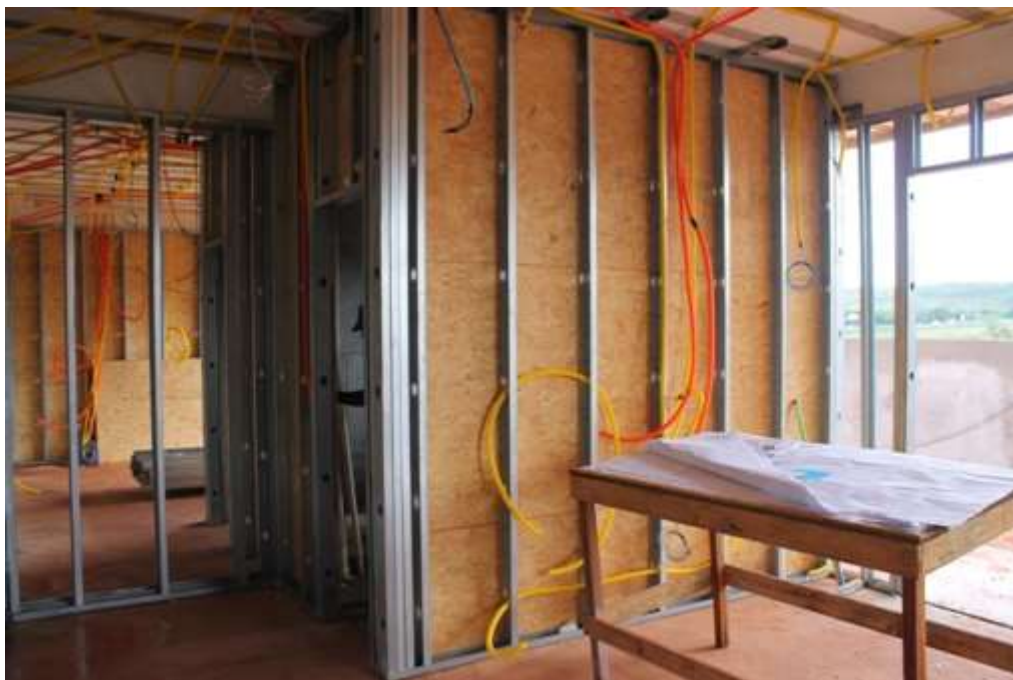
Figura 19 – Instalações elétricas e hidráulicas na parede interna Fonte: Arqitetando com a lara, 2014
