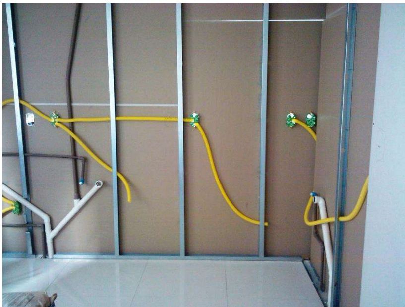
Figura 5 – Instalações sanitária e elétrica Fonte: Habitíssimo, 2012
