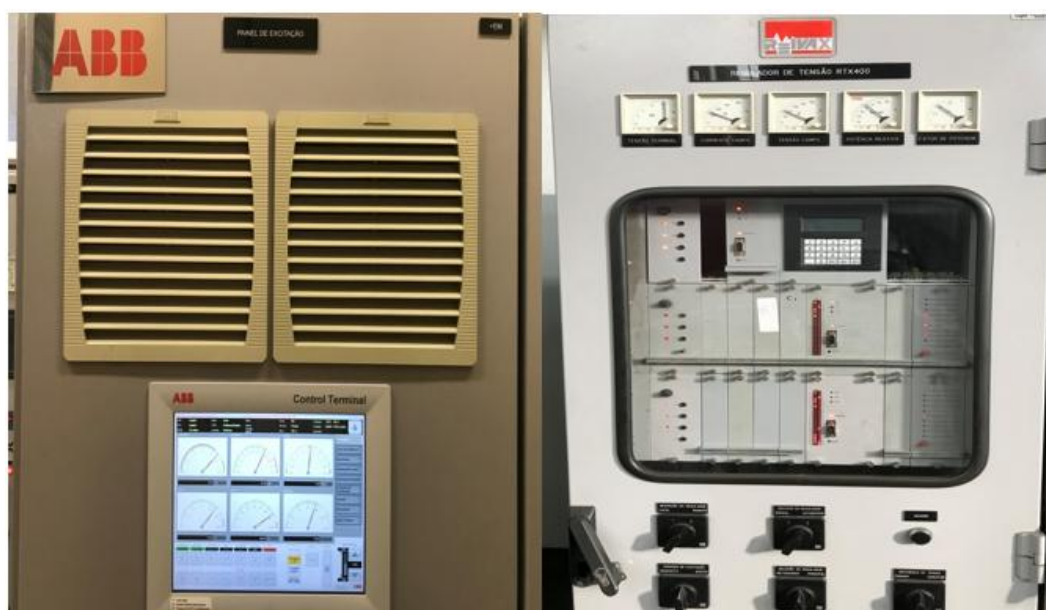
Figura 17 - Reguladores de tensão
