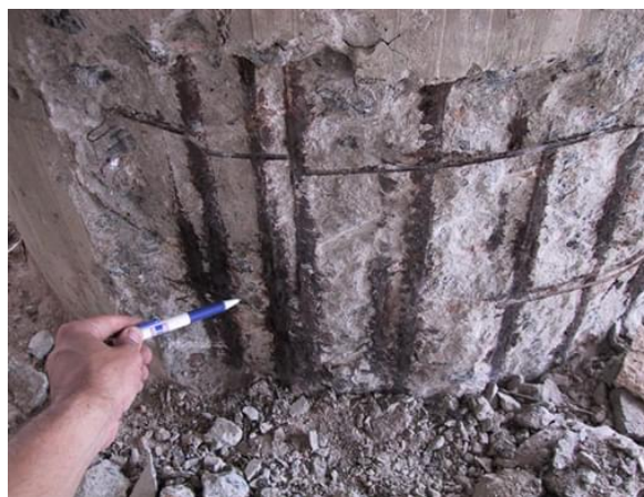
Figura 9 - Carbonatação do concreto causando fissuras e expondo as armaduras
