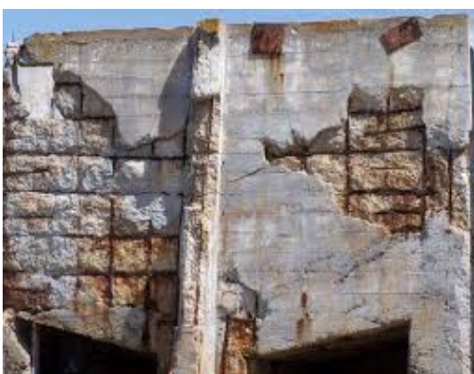
Figura 7 - Desagregação da estrutura de concreto armado.
