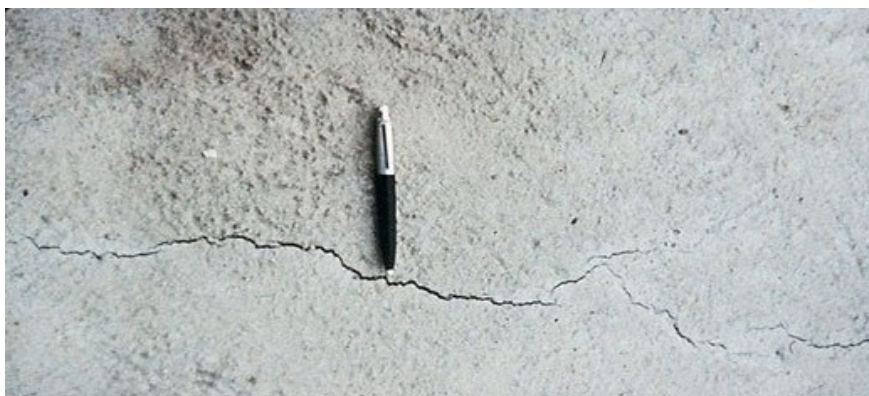
Figura 12 - Fissura de retração do concreto.
