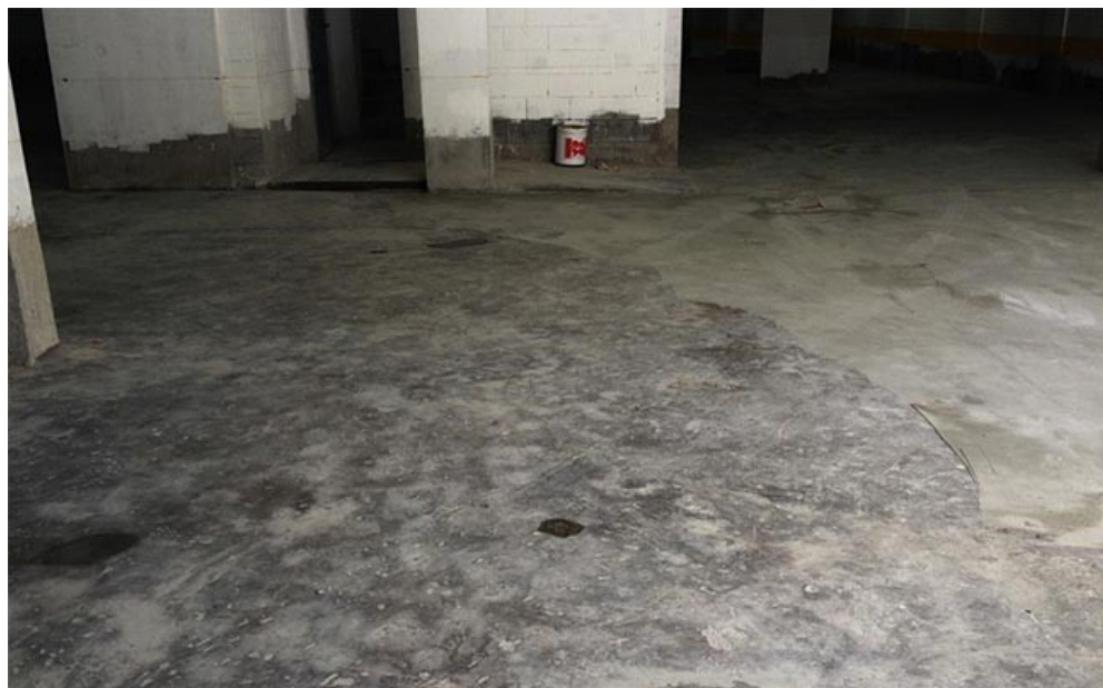
Figura 6 - Desgaste do piso de concreto.
