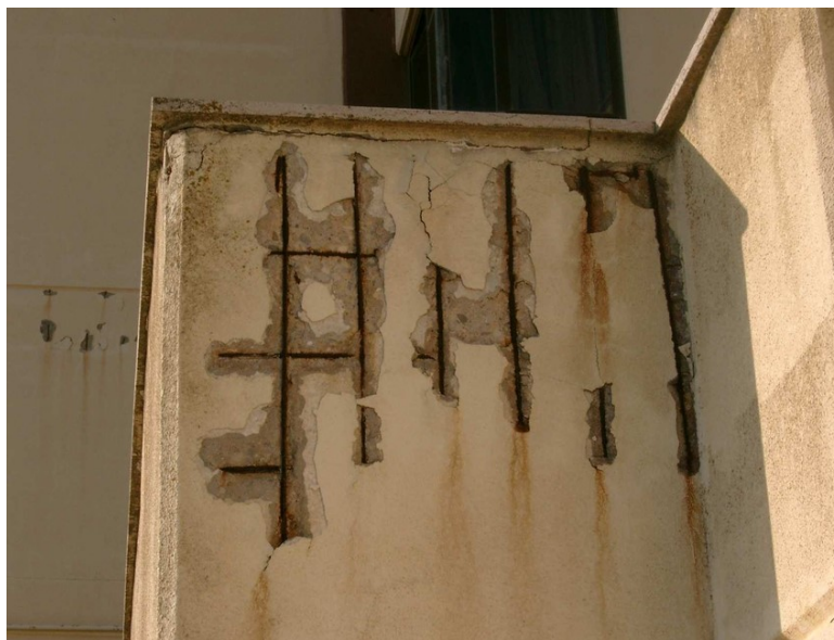
Figura 3 - Exemplo de corrosão por falta do cobrimento mínimo necessário.
