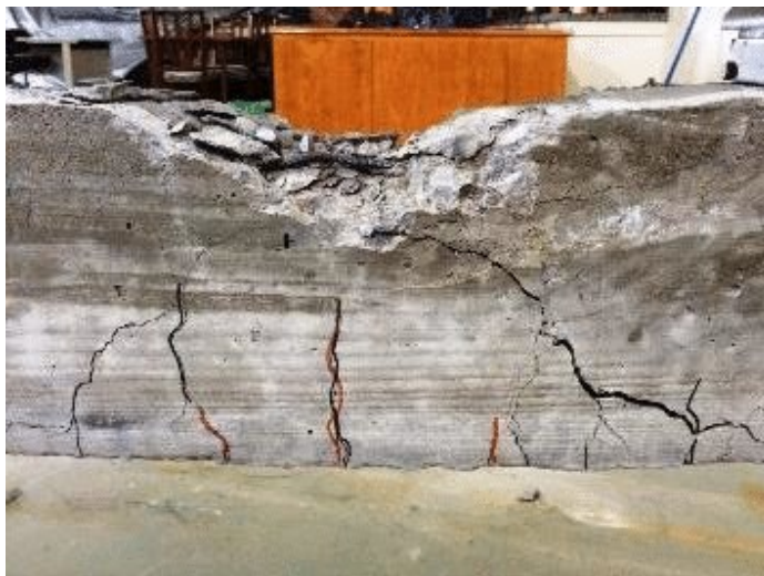
Figura 5 - Esmagamento do concreto armado.
