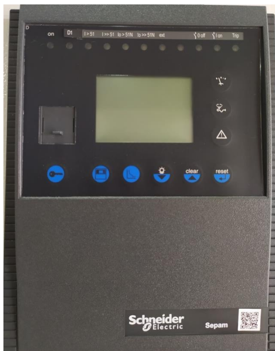
Figura 36 - Relé de proteção SEPAM Fonte: Autores (2020).
