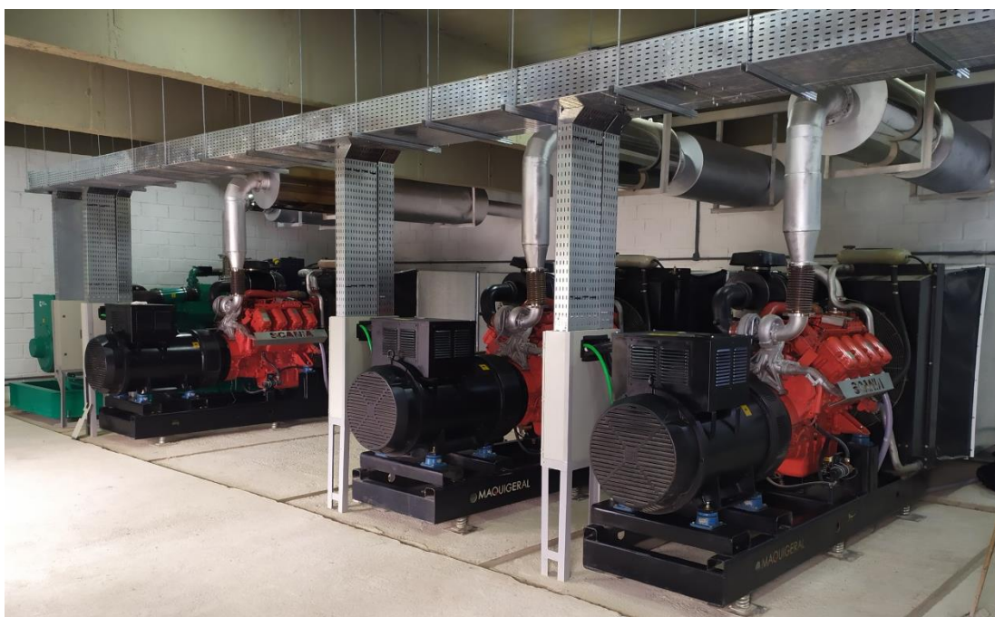
Figura 27 – Usina geradora do hospital Unimed de Volta Redonda Fonte: Autores (2020).
