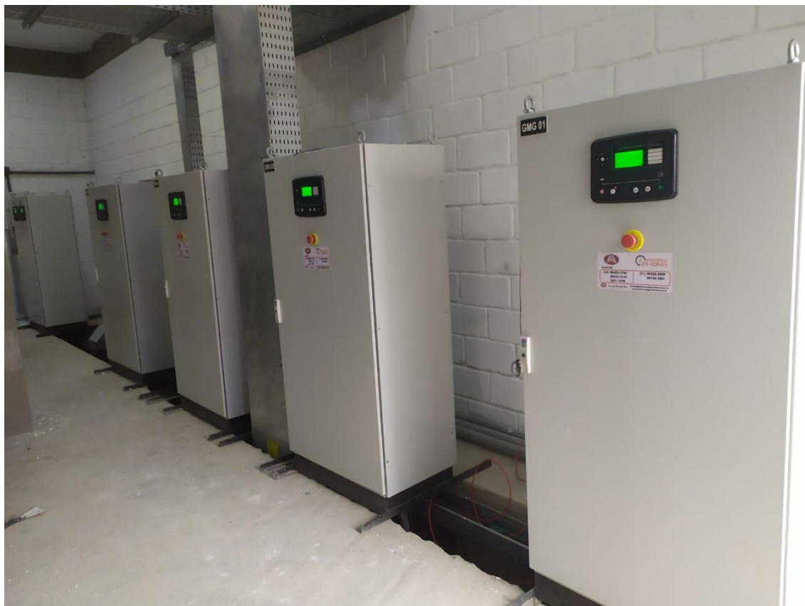
Figura 29 - Quadros de comando Fonte: Autores (2020).
