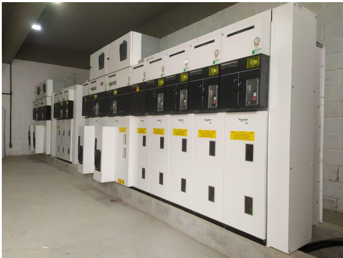
Figura 35 - Painéis de média tensão Fonte: Autores (2020).
