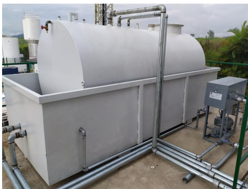
Figura 28 - Reservatório de óleo diesel de 5.000 litros Fonte: Autores (2020).
