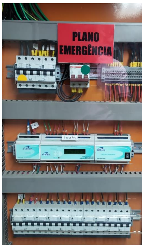
Figura 23 – Disjuntores do quadro com plano emergencial Fonte: Autores (2020).
