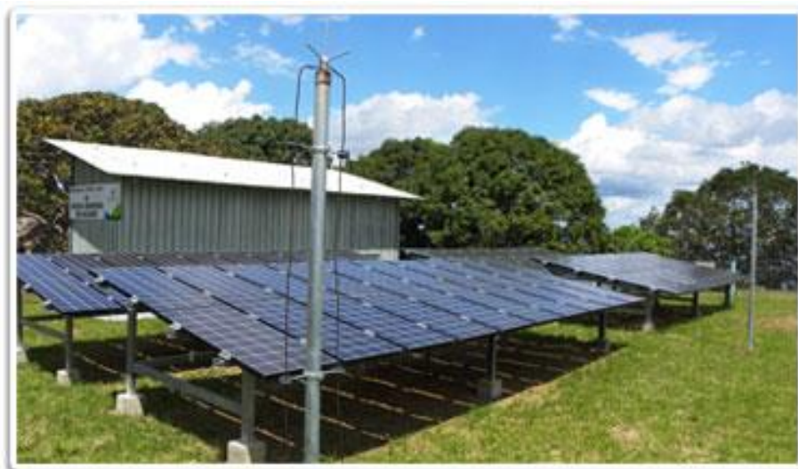
Figura 16: Mini Usina Fotovoltaica Fonte: ANEEL
