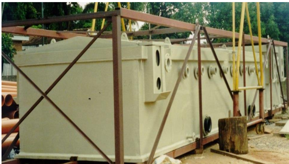
Figura 1. Tanque de decapagem ácida.
