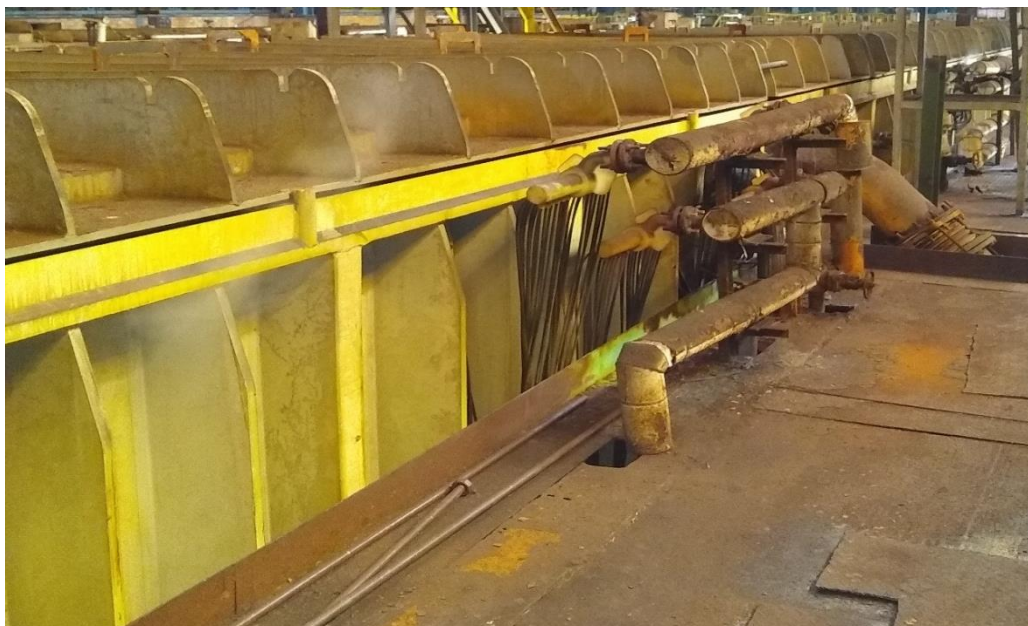
Figura 41. Tanques de Decapagem.
