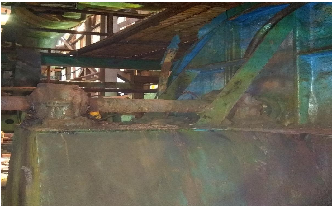
Figura 38. Efeitos da ineficiência do sistema de exaustão.
