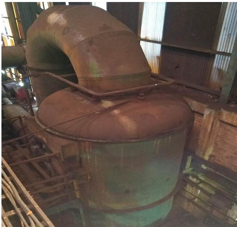
Figura 39. Lavador de Gás.
