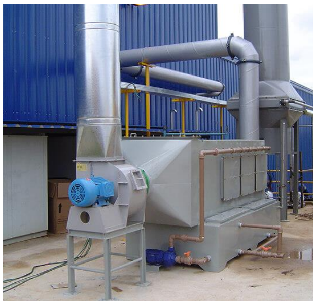
Figura 17. Lavador de gás.
