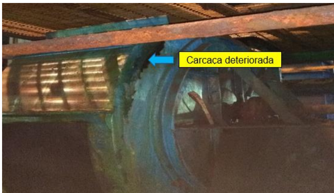
Figura 37. Estado de conservação do Ventilador.
