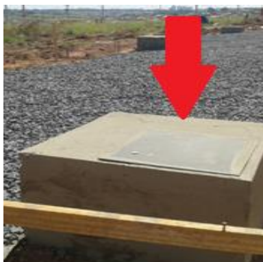
Figura 35: Placa de aço na superfície do container.
