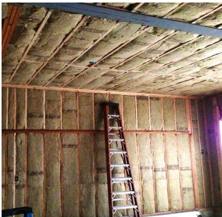
Figura 23: Lã de rocha instalada em áreas internas de residências
