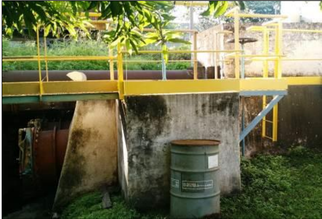
Figura 6: Caixa de recepção de efluentes.
