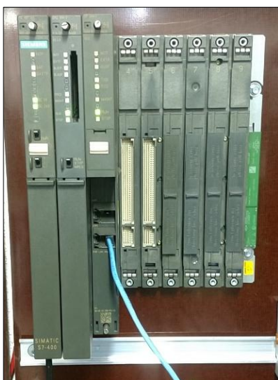
Figura 57 – Montagem do CLP Fonte: Autores (2018)
