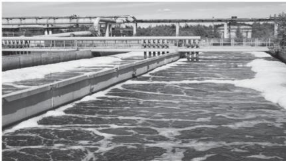
Figura 17: tanque de aeração artificial de lodos ativados.
