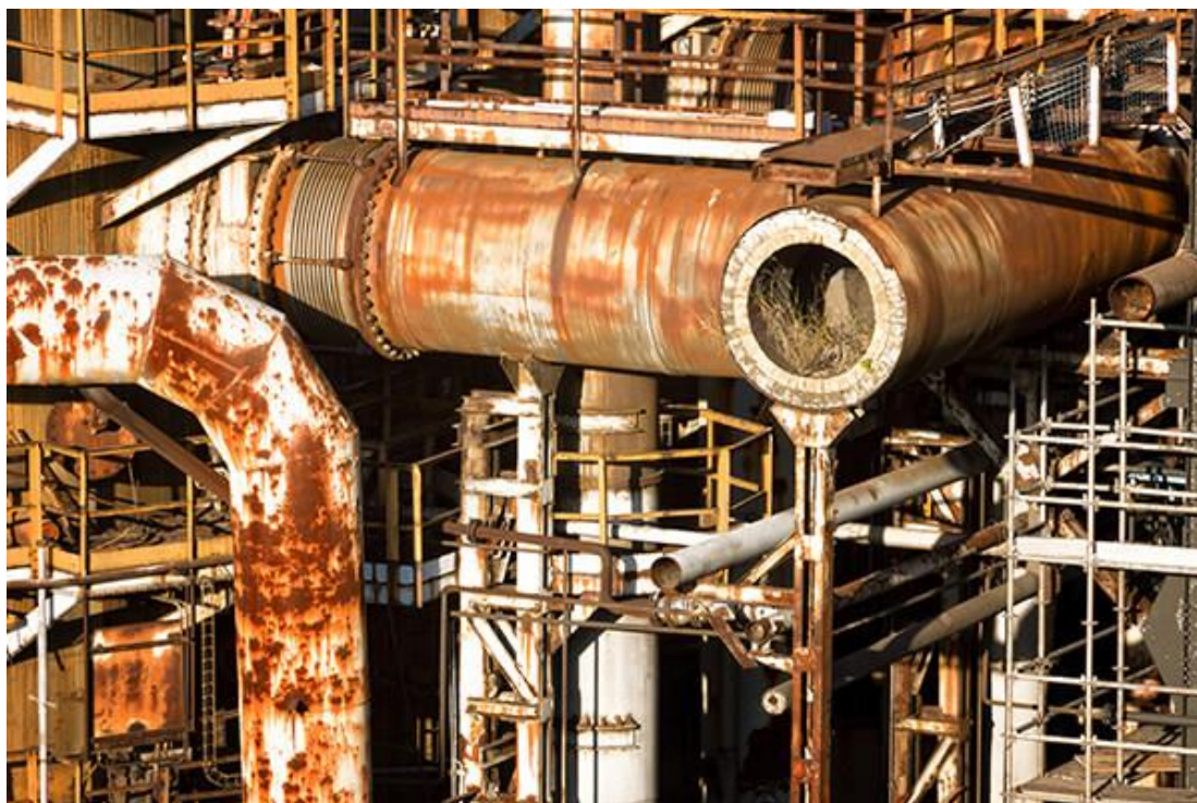
Figura 8 Estrutura metálica com avançado processo de corrosão.
