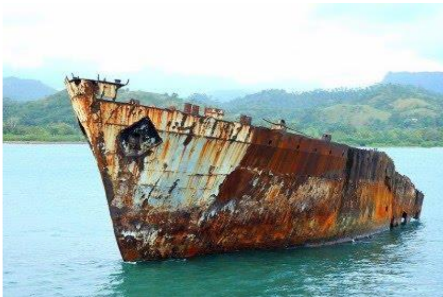
Figura 9 Estrutura naval em avançado processo corrosivo e submetido à atmosfera extremamente corrosiva.
