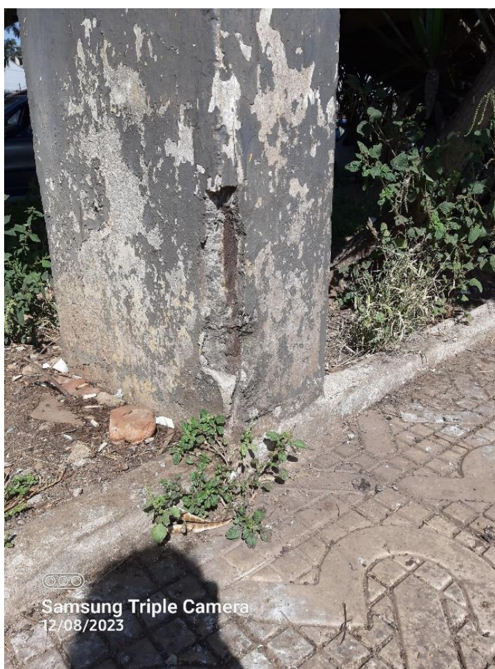
Figura 20: Pilar 1 com perda de parte da camada de cobrimento de concreto.
