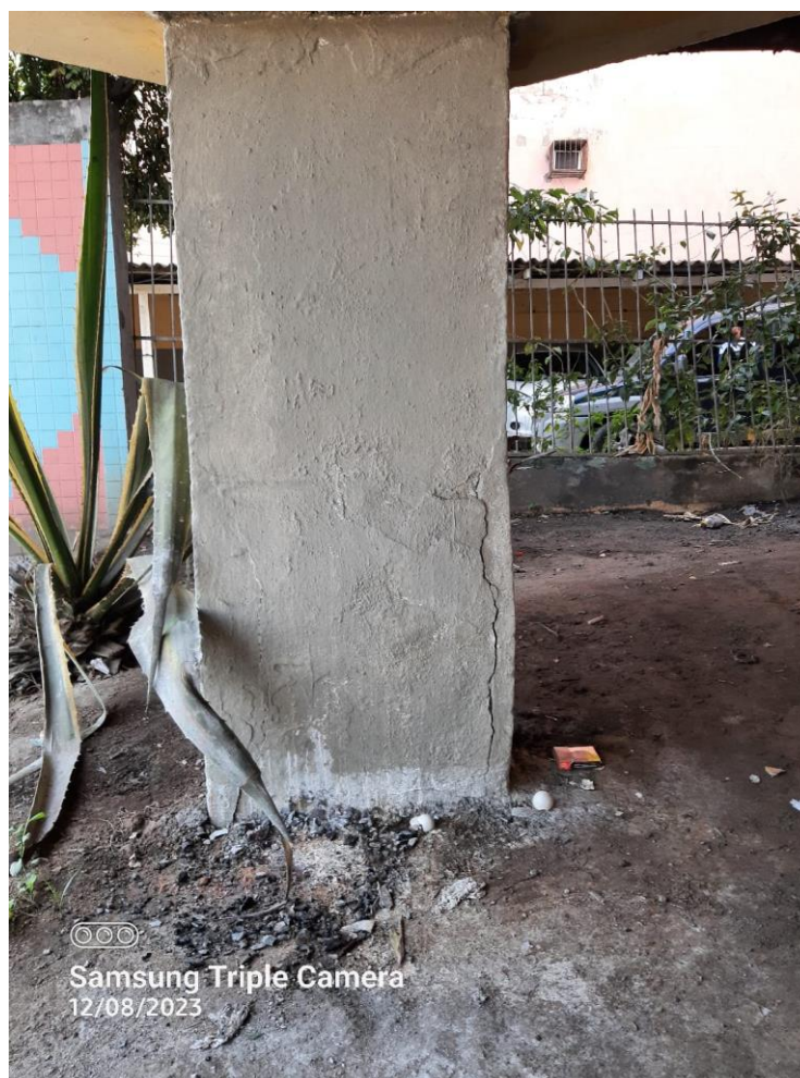
Figura 27: Pilar 5 – Trinca por Etringita Tardia
