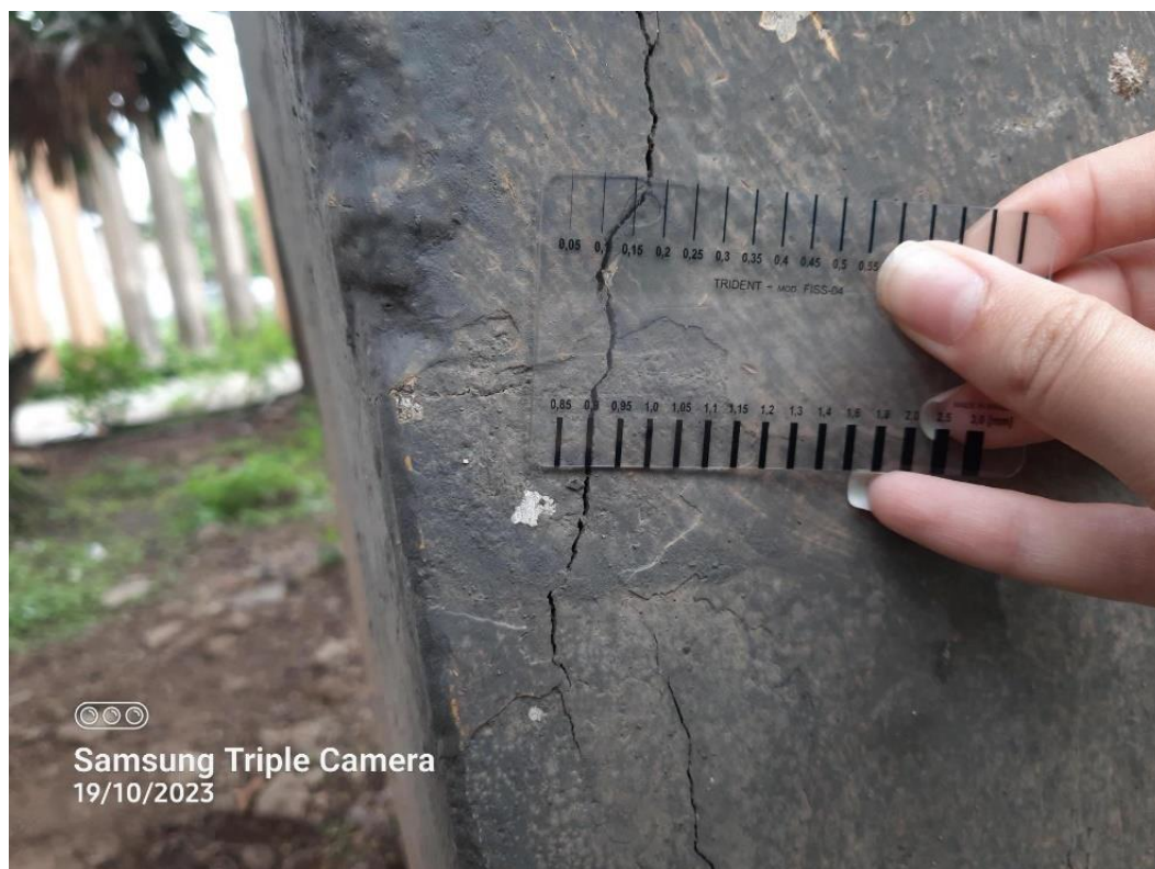
Figura 25: Pilar 3 – Trinca por Despassivação do Aço
