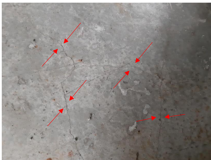
Figura 3: Retração Plástica do Concreto
