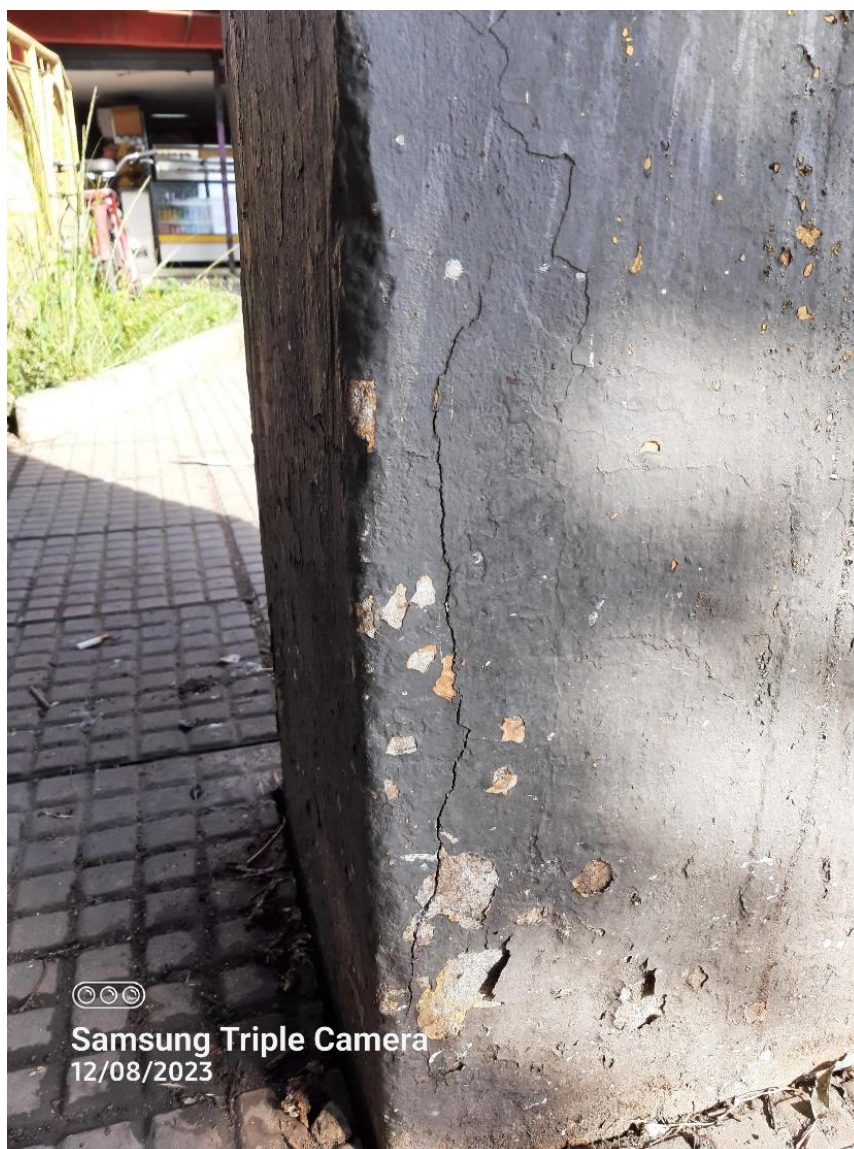
Figura 24: Pilar 2 – Trinca por Carbonatação
