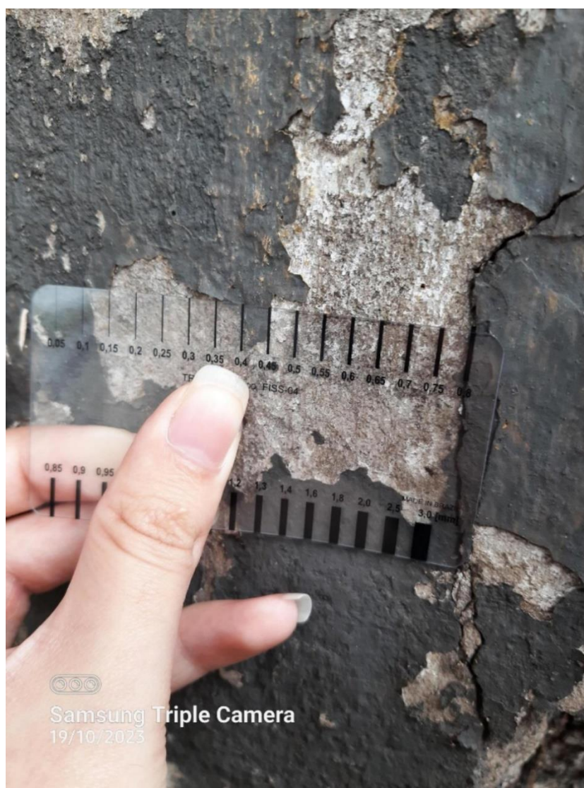
Figura 21: Pilar 1 com Trinca de 0,5mm.
