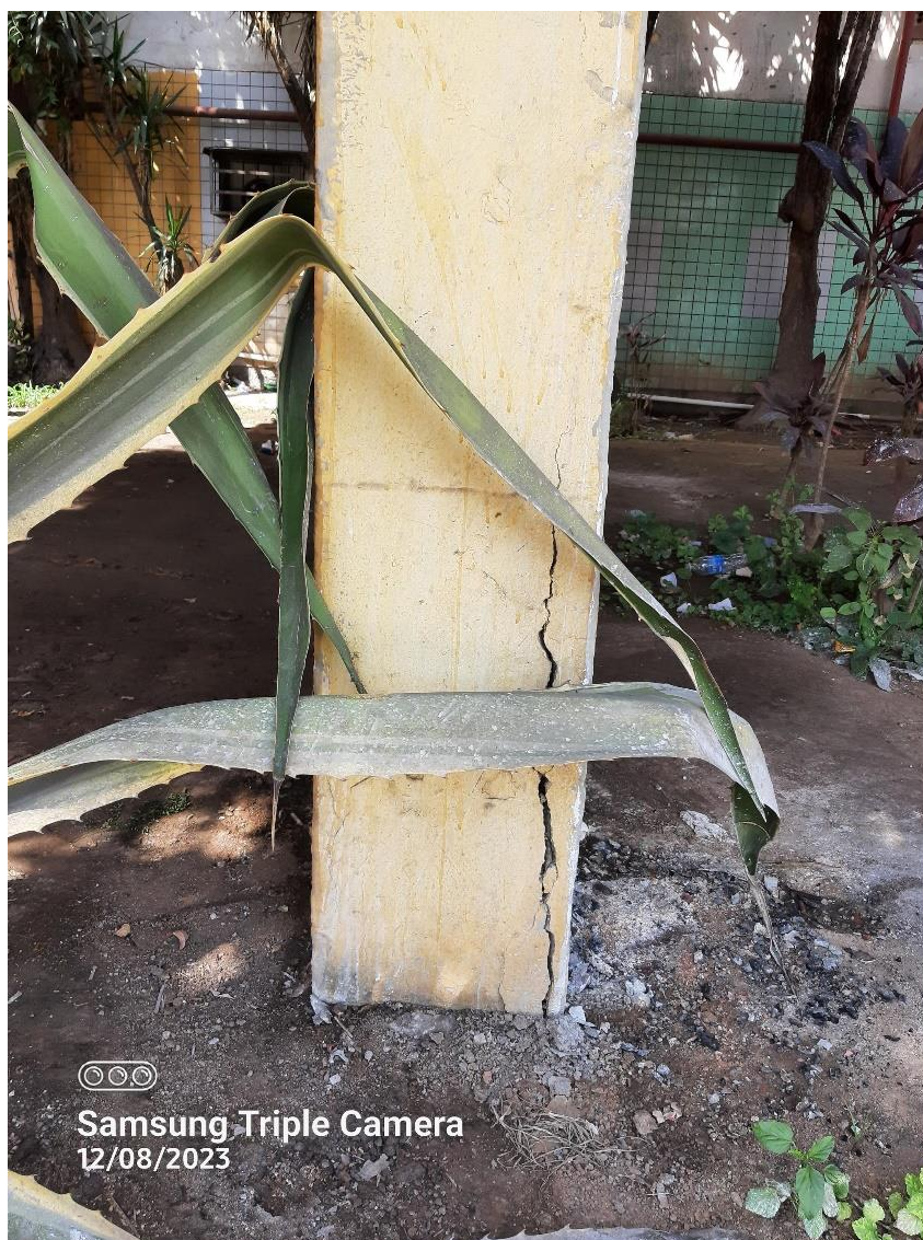
Figura 28: Pilar 6 – Rachadura por Etringita Tardia
