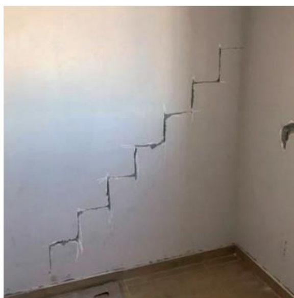
Figura 13: Trincas por tensão interna de cisalhamento ocasionada pela dilatação térmica da laje.
