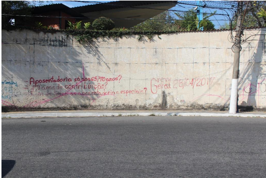
Figura 29: Muro Vila Sta. Cecília – Antes.
