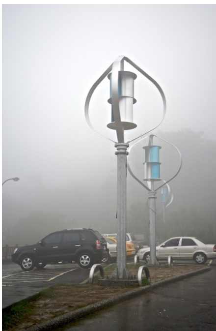
Figura 26- Turbina Savonius- Darrieus instalada na cidade Jinguashi, Taiwan- China.
