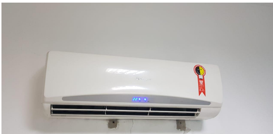
Figura 17: Ar condicionado novo Fonte: Autores
