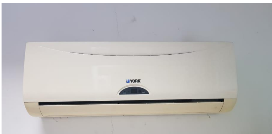
Figura 16: Ar condicionado antigo com defeito Fonte: Autores
