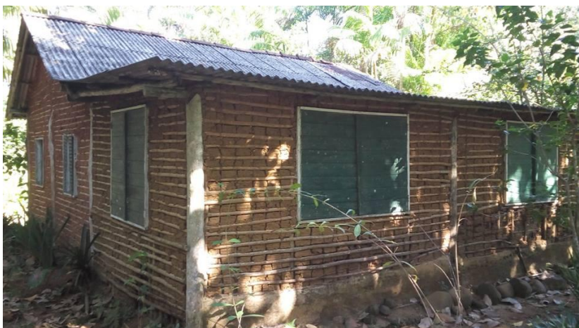
Figura 5: Casa de pau a pique caiçara – Praia do Sono – Paraty Fonte: Autores – 2016
