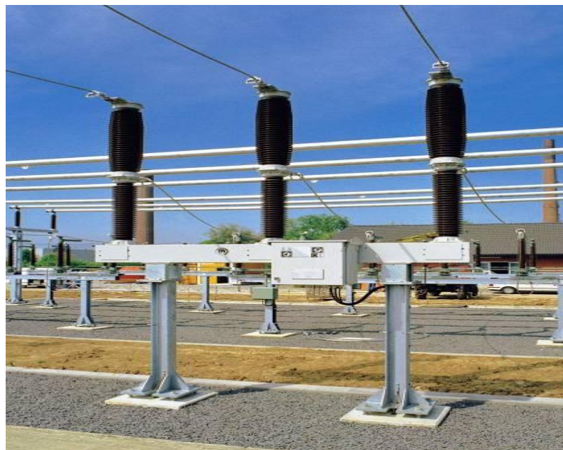
Figura 10 - Disjuntor SF6 Fonte: El-Insta, Alstom, 2019.
