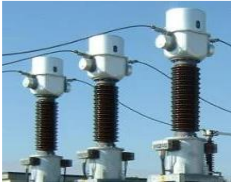
Figura 3 - Transformador de corrente tipo bucha Fonte: Grupo Arteche, 2019.
