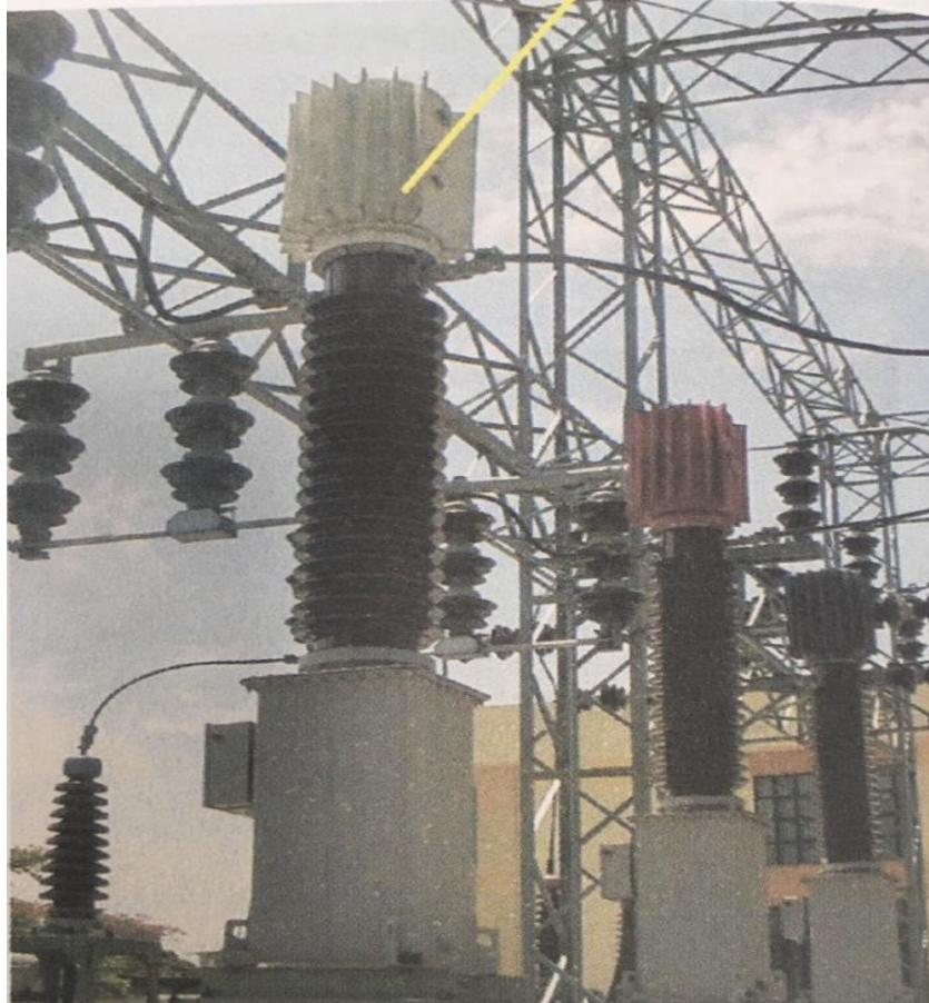
Figura 6 - Transformador de corrente tipo pedestal
