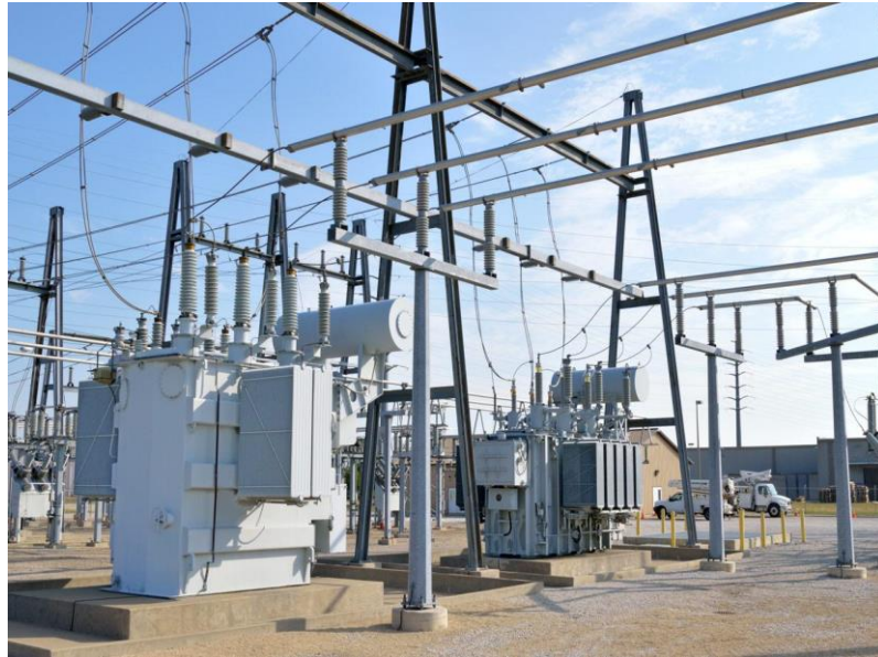
Figura 2 - Exemplo de uma subestação Fonte: Elfi Engenharia e Arquitetura, 2011.
