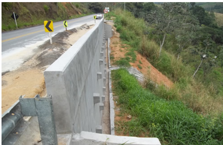
Figura 8: Drenagem na cortina atirantada
