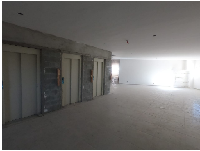
Figura 19 – Elevadores torre de apartamentos de 28,80m 2 Fonte: Condomínio da Fé (2020).
