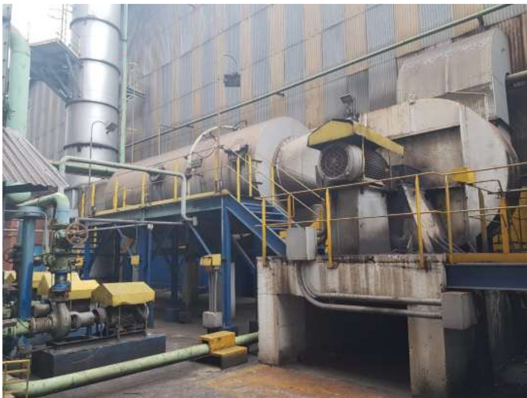
Figura 46 Sistema de exaustor do LER.
