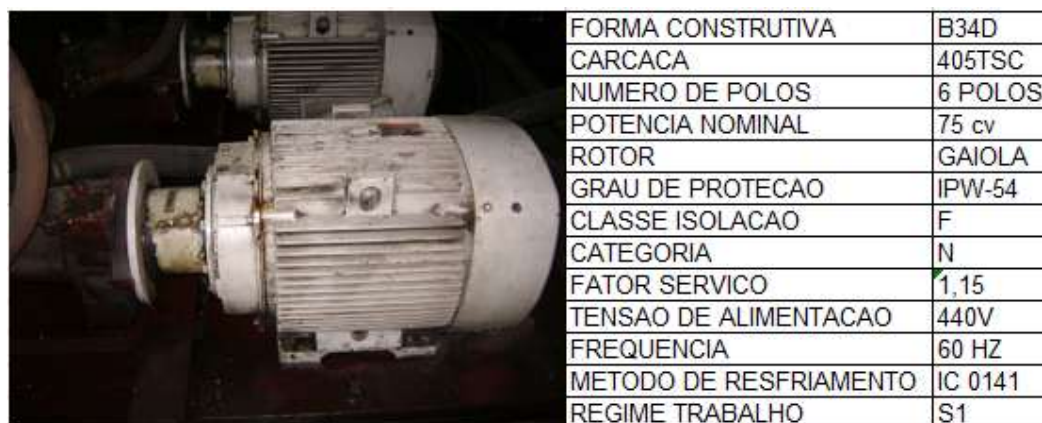
Figura 45 Motor do sistema hidráulico central
