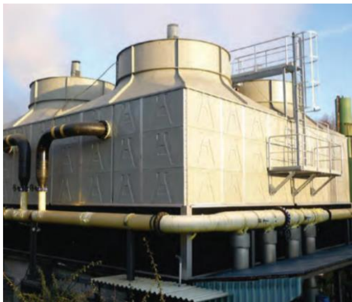
Figura 19. Torre de tiragem mecânica induzida
