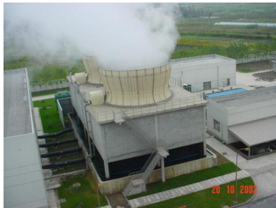
Figura 2. Torre de resfriamento de tiragem mecânica
