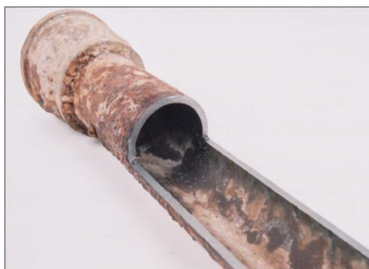
Figura 29. Corrosão em tubulação
