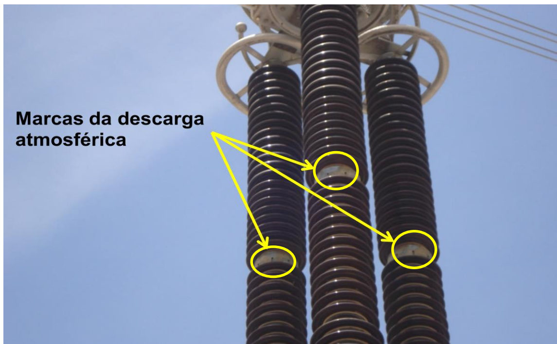
Figura 13 - Isolador de pedestal da bobina de bloqueio da fase Branca do circuito C1 na SE de Itaberá. Fonte: ONS [13]
