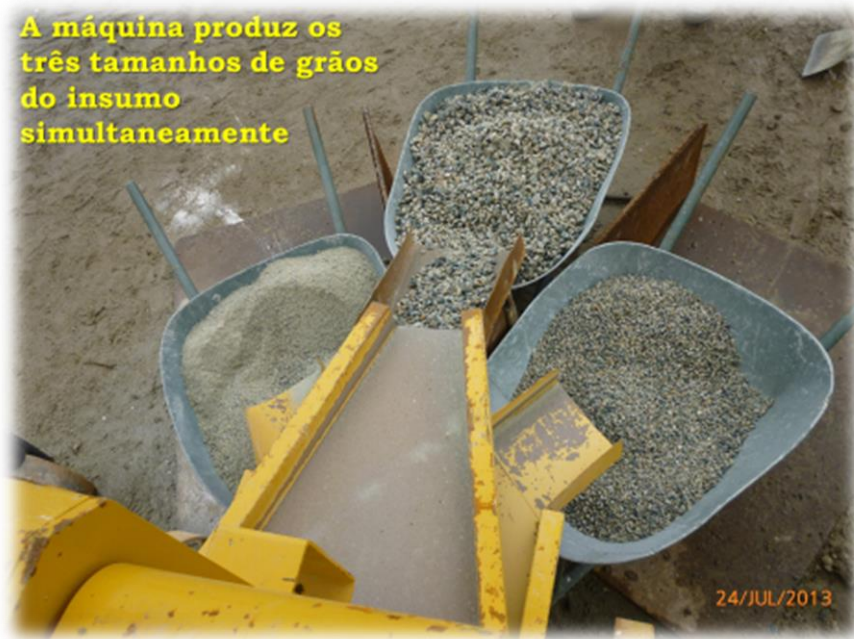
Figura 49 - Estação de reciclagem de entulho
