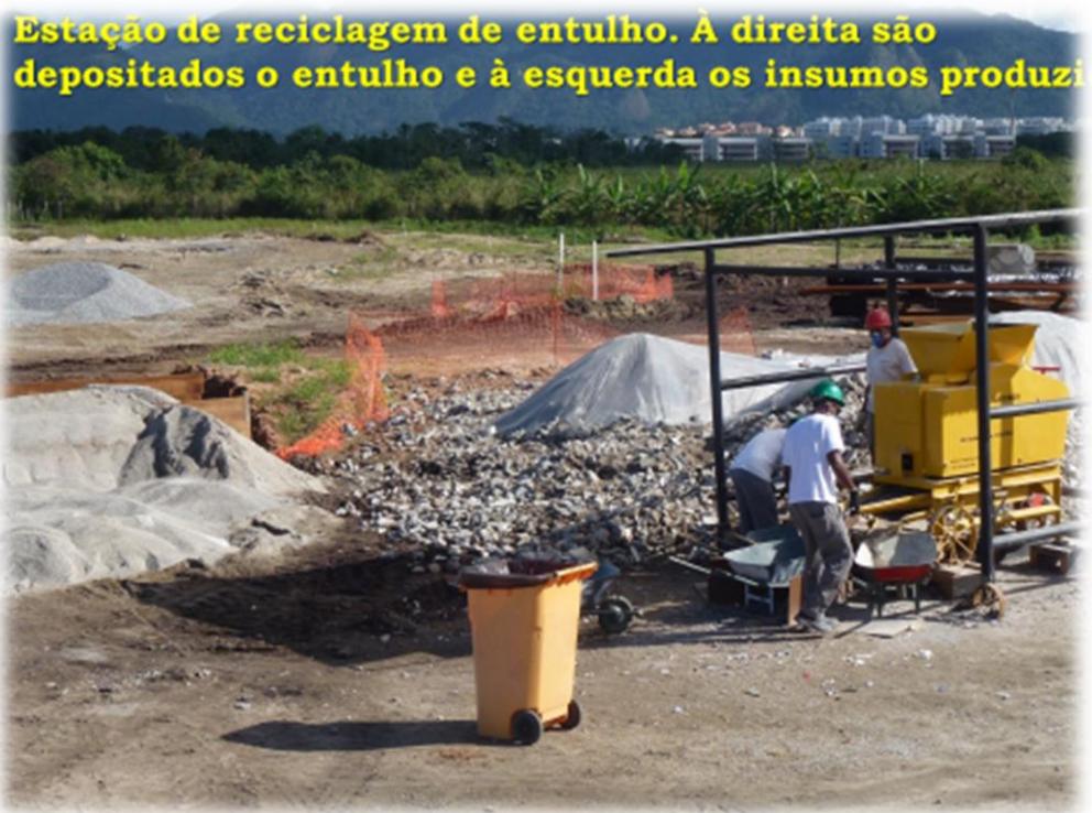
Figura 46- Estação de reciclagem de entulho.
