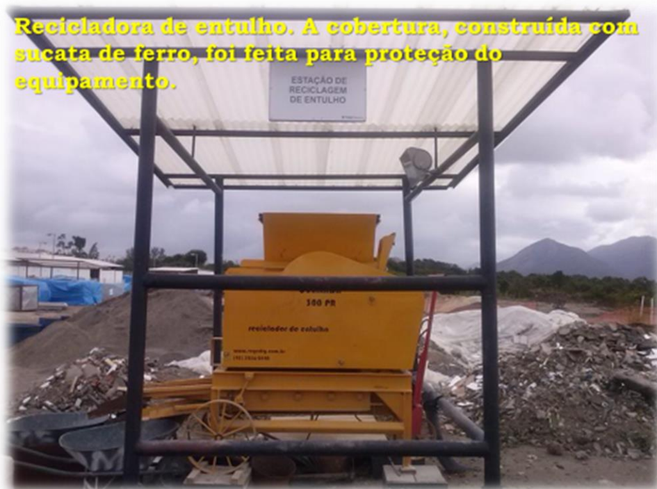
Figura 45- Estação de reciclagem de entulho Fonte: Acervo Pessoal do Engenheiro e Gerente de Meio Ambiente Francis Fixel, 2013 .
