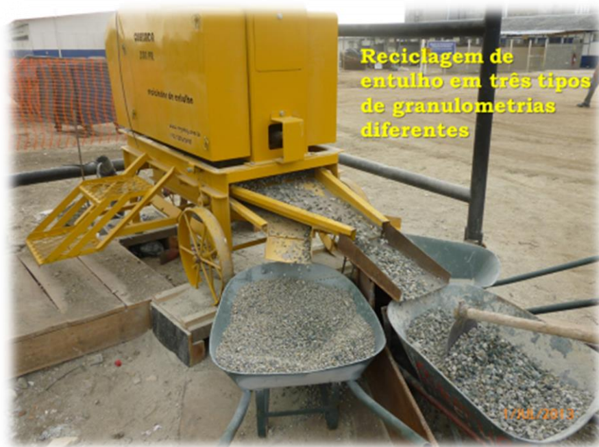
Figura 48- Estação de reciclagem de entulho
