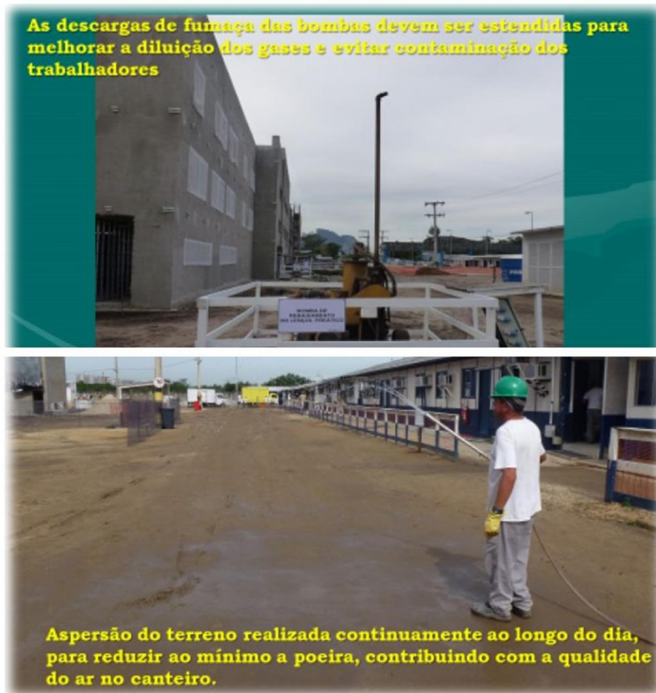
Figura 8- Controle da poluição do ar externo / interno
