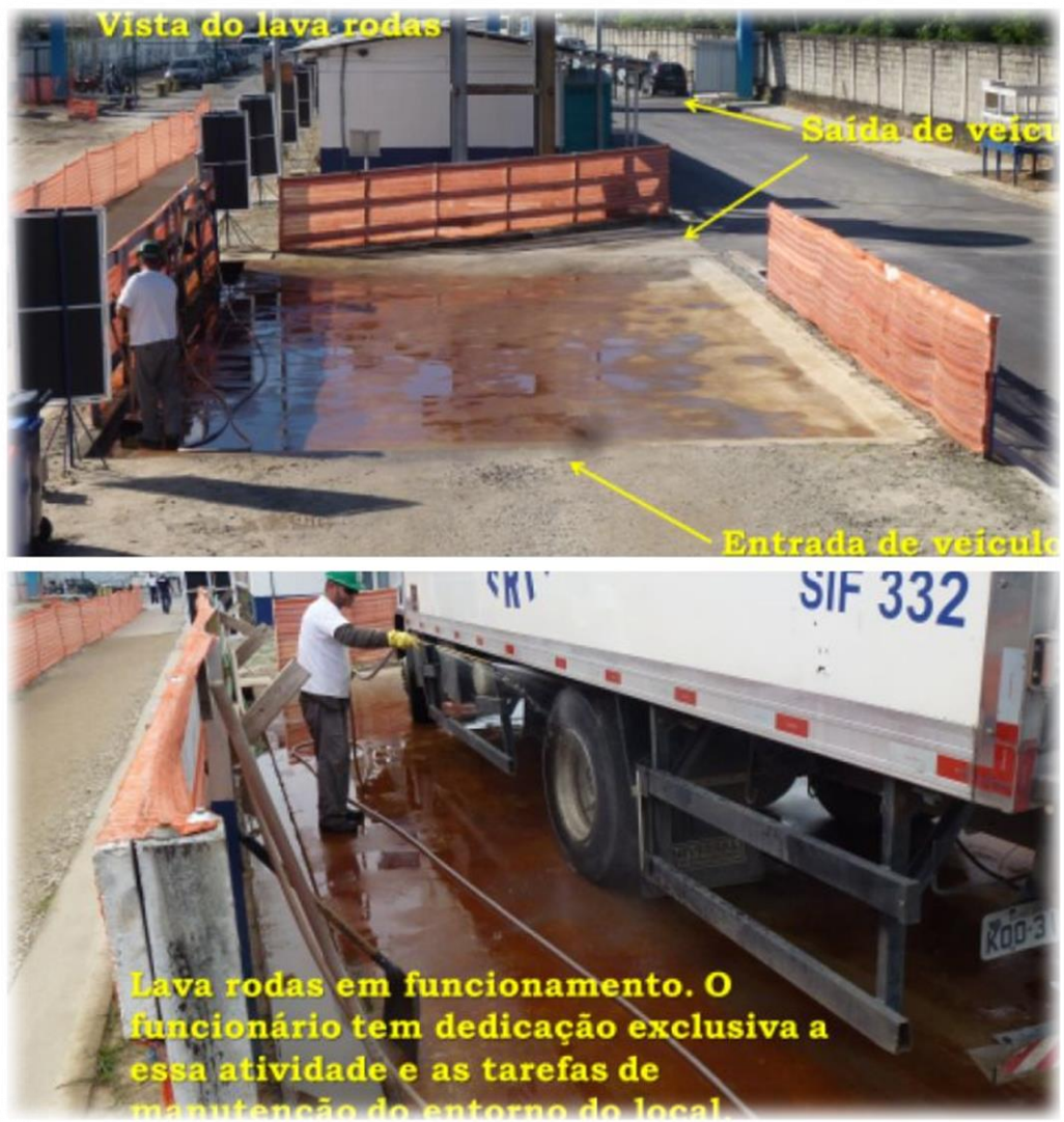
Figura 23- Controle da contaminação externa Fonte: Acervo Pessoal do Engenheiro e Gerente de Meio Ambiente Francis Fixel, 2013.
