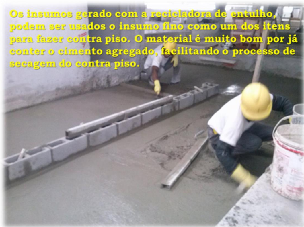
Figura 52 - Estação de reciclagem de entulho
