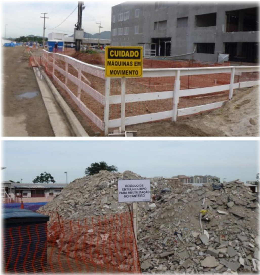
Figura 20- Controle de gerenciamento de tráfego para obras Fonte: Acervo Pessoal do Engenheiro e Gerente de Meio Ambiente Francis Fixel, 2013.
