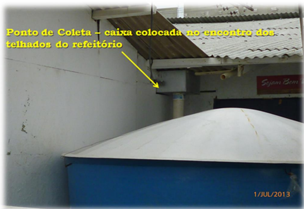
Figura 57- Águas de Reuso
