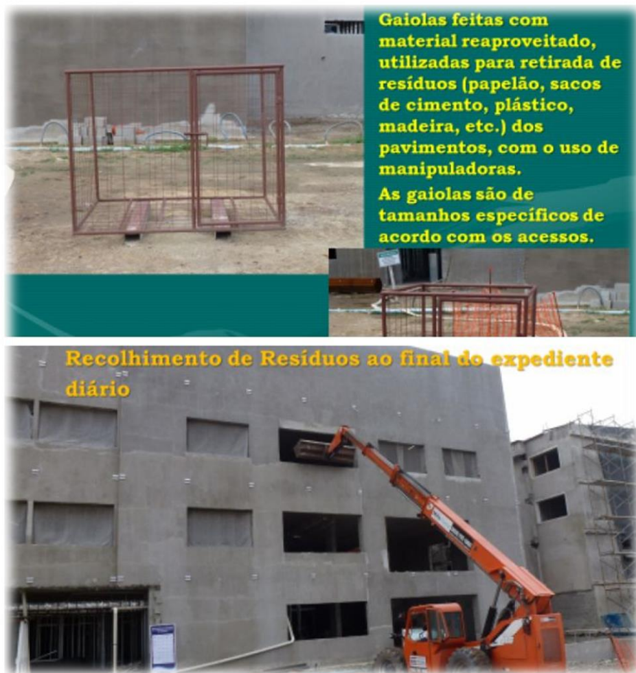
Figura 11- Segregação de Resíduos
