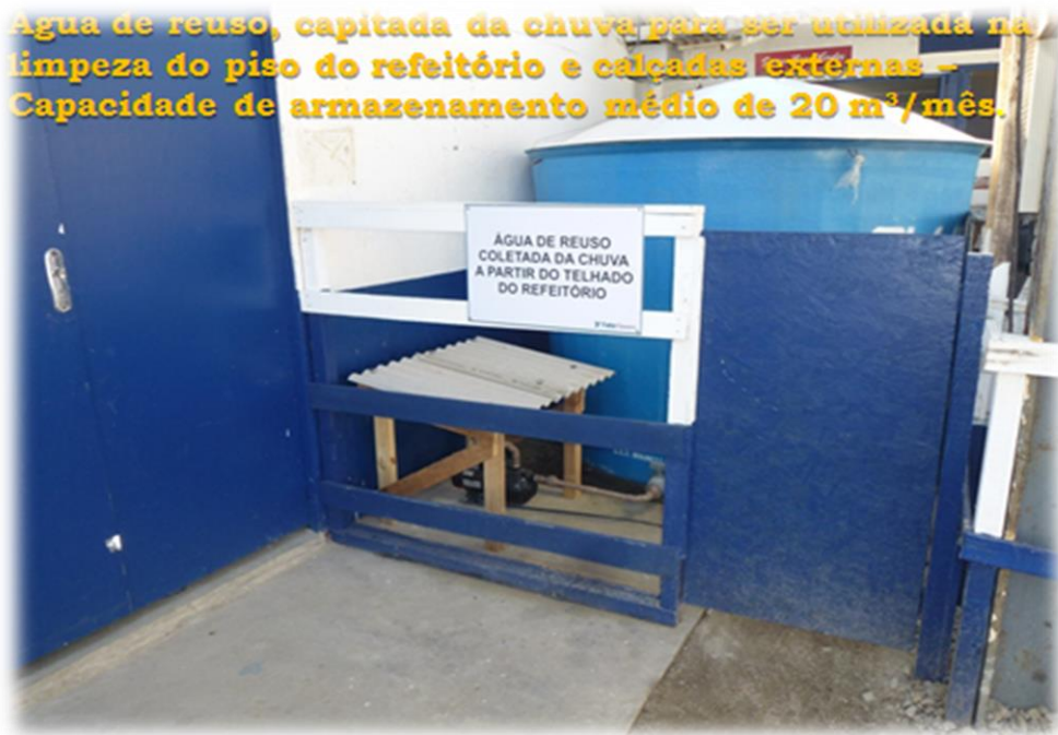
Figura 56- Águas de Reuso
