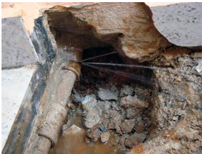
Figura 4 - Vazamento de tubulação
