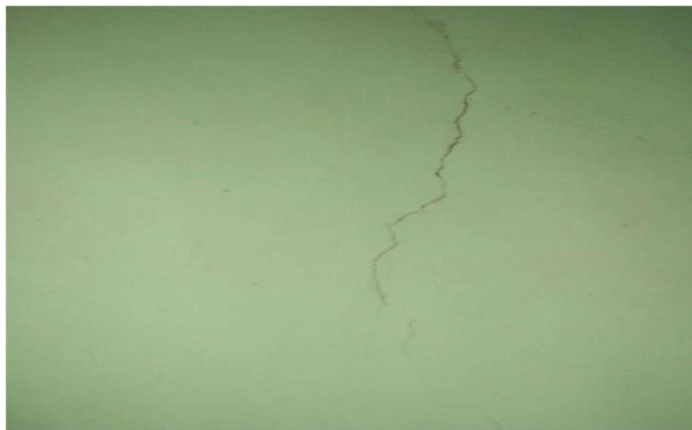
Figura 7 - Fissura vertical na alvenaria
