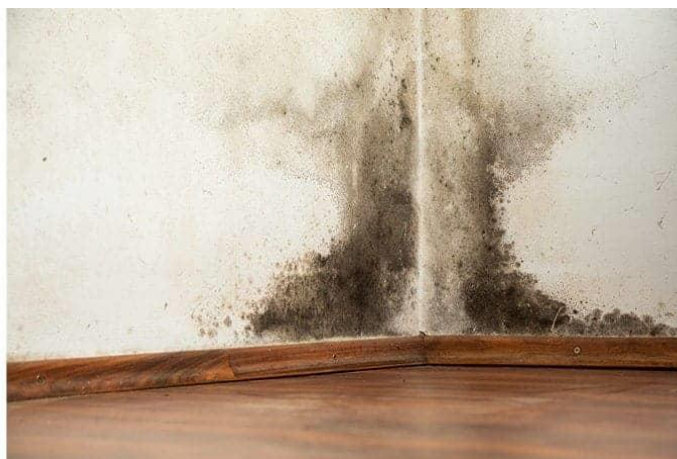
Figura 6 - Superfície com presença de mofo
