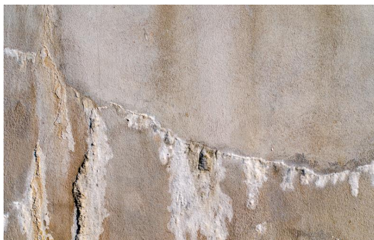
Figura 5 - Eflorescência em parede
