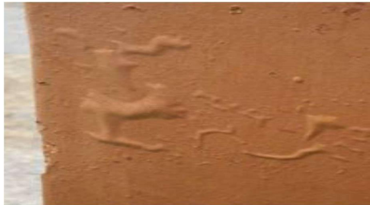
Figura 8 - Bolhas na pintura
