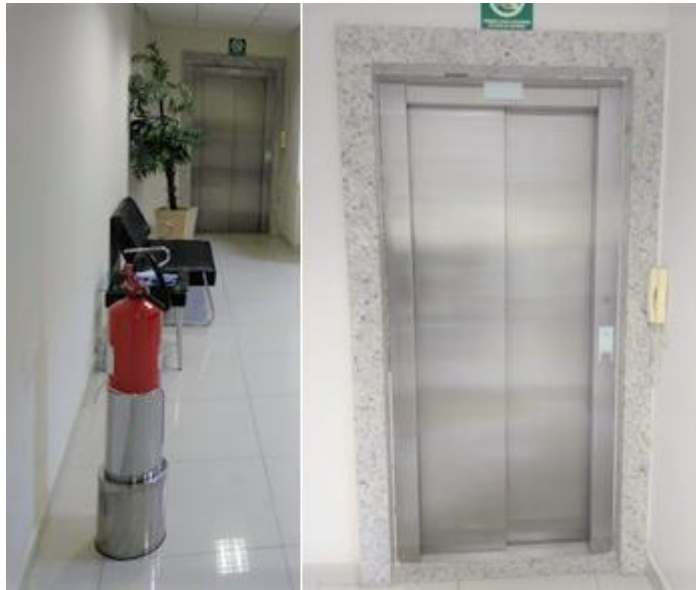
Figura 34: Elevador sem sinalização
