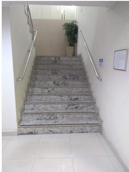
Figura 33: Escada sem sinalização Fonte: Autores (2020)
